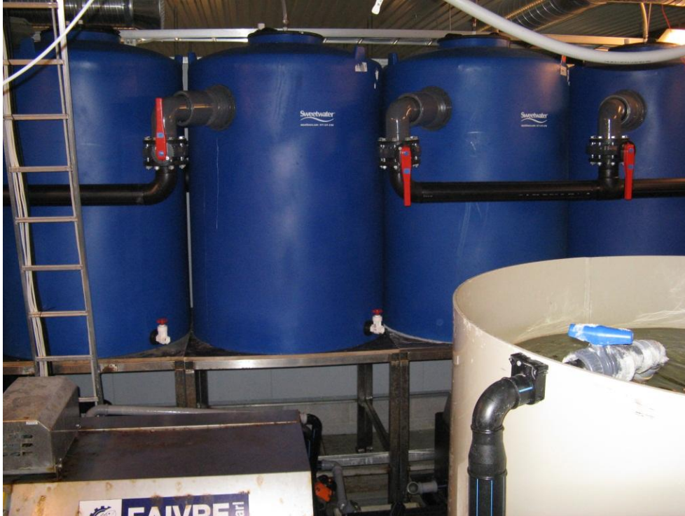
Kuva 4. Kiertovesilaitoksen suodattimia. Vasemmassa alakulmassa on rumpusuodatin, siniset ovat ”moving bed”-biosuodattimia.
