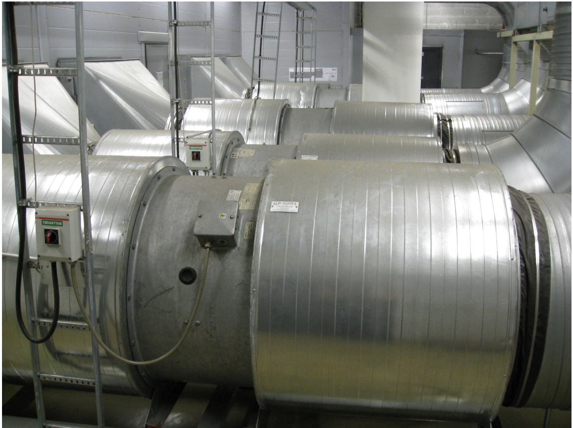
Kuva 4: Kaukoliikenneterminaalin liikennöntialueelle ulkoilmaa puhaltavia aksiaalipuhaltimia.
