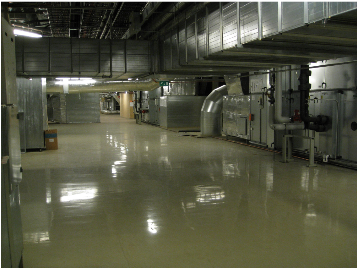
Kuva 17: Kampin keskuksen suurin IV-konehuone.
