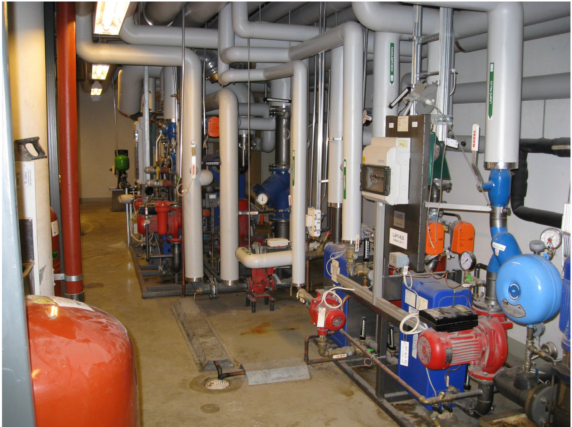
Kuva 19: Erään lämmönjakohuoneen lämpöpaketteja.
