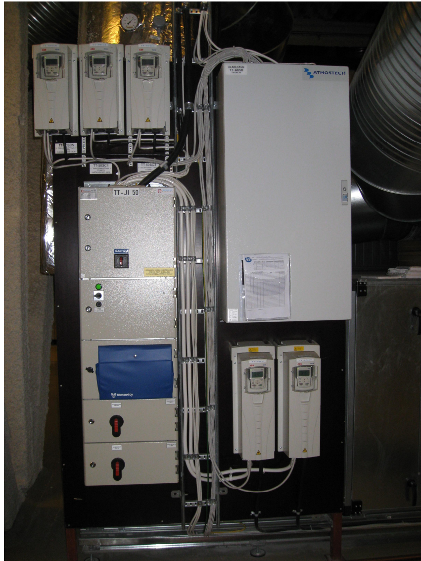
Kuva 5: Yhden ilmanvaihtokoneen sähkö- ja ohjauskeskus. Sähkönsyötön lisäksi kuvassa näkyvät automaatioalakeskus sekä sähkömoottoreita ohjaavat taajuusmuuttajat.
