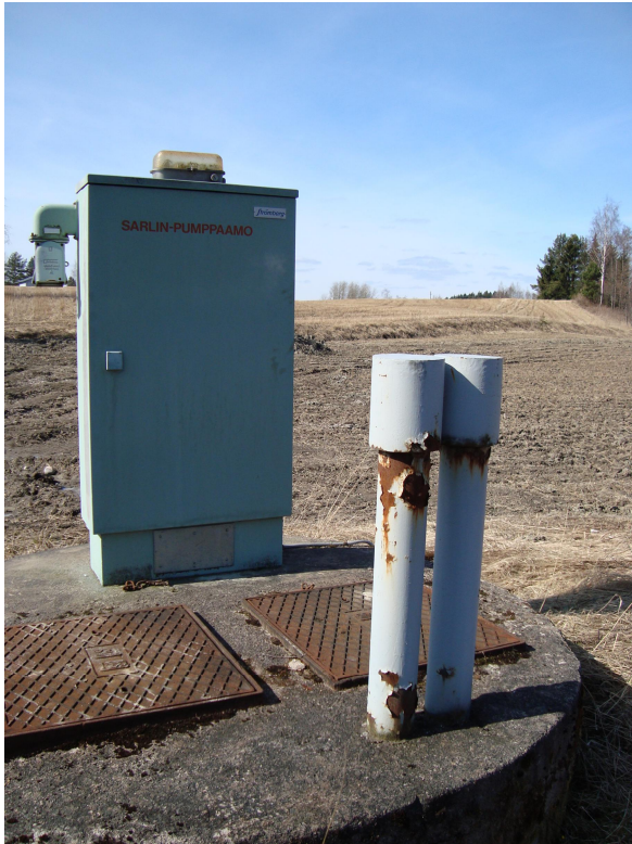
Kuva 3. Vanhan mallin Sarlin- pumppaamo
