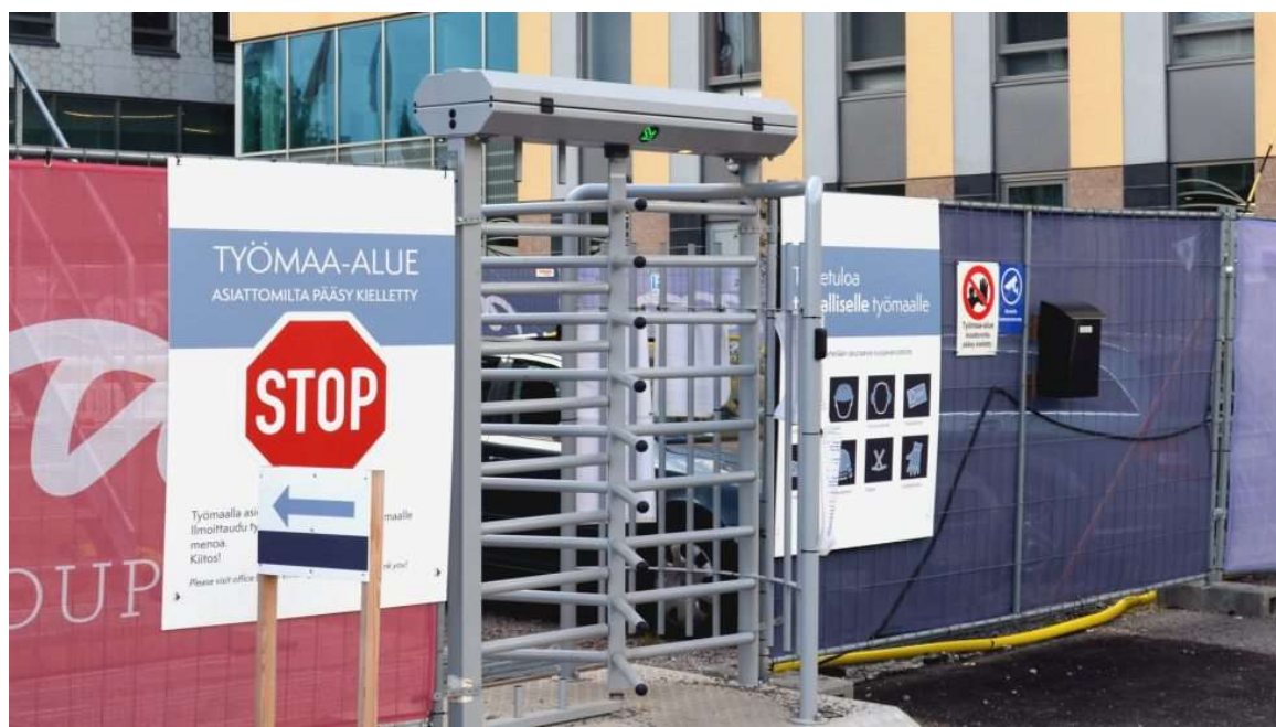
Kuva 10. Esimerkki työmaan kulunvalvonnasta. Sisään- ja ulospääsyportin oikean puolisessa pylväässä on musta leimausrekisterilaite, johon leimaamalla portti avautuu [30].
