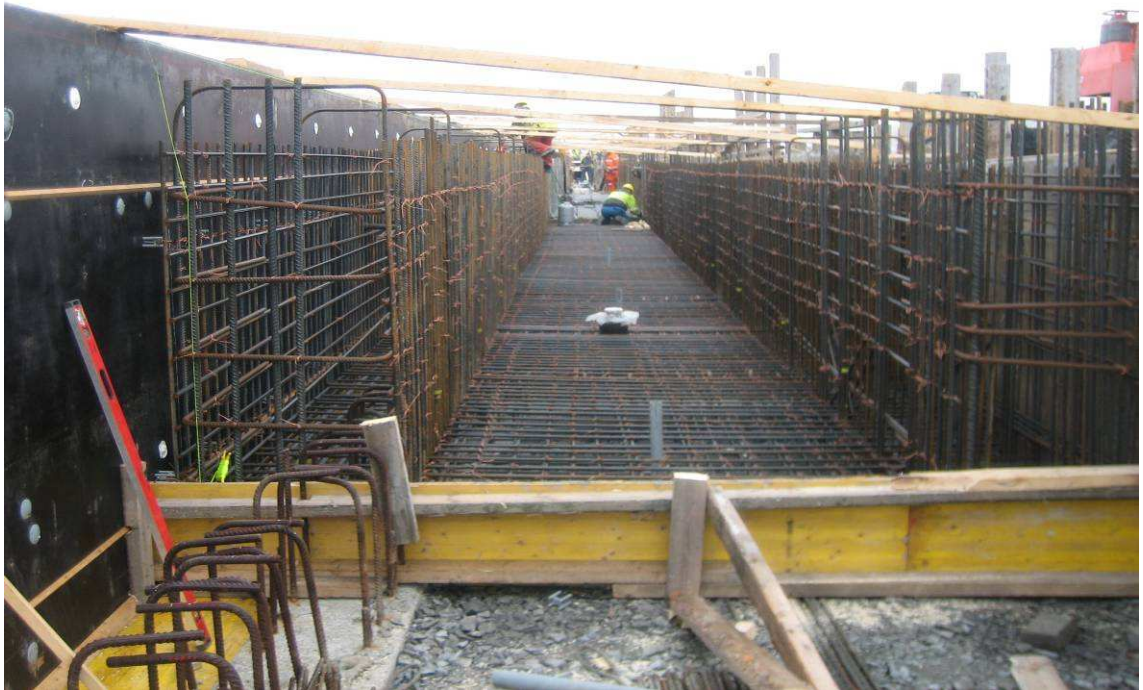
Kuva 25. Mittamies on asettanut teippimerkit valumiehille tunnelilaiturin pohjalaatan valua varten. Reunapalkkien ja pohjalaatan valukorkeutta osoittava kulmarima on paikoillaan. Raudoitushakasten korkeus on asennettu mittamiehen asettamien merkkien perusteella.
