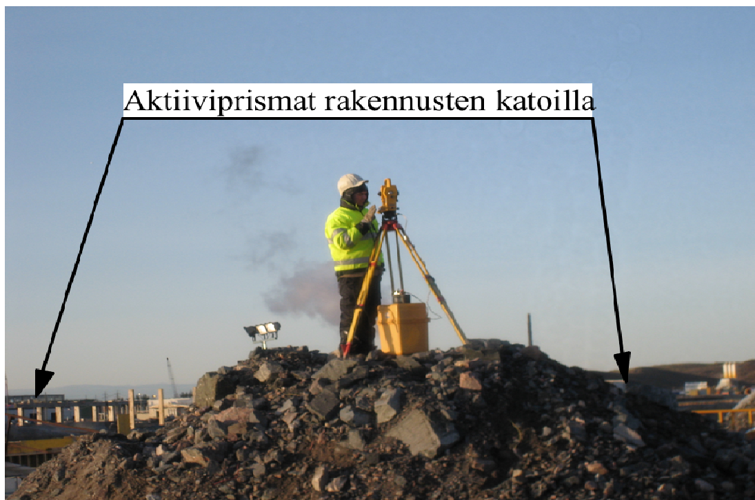
Kuva 36. Viralliset aktiiviprismat sijaitsivat aivan liian kaukana ja näkyvyys työmaalta prismoille oli keho.
