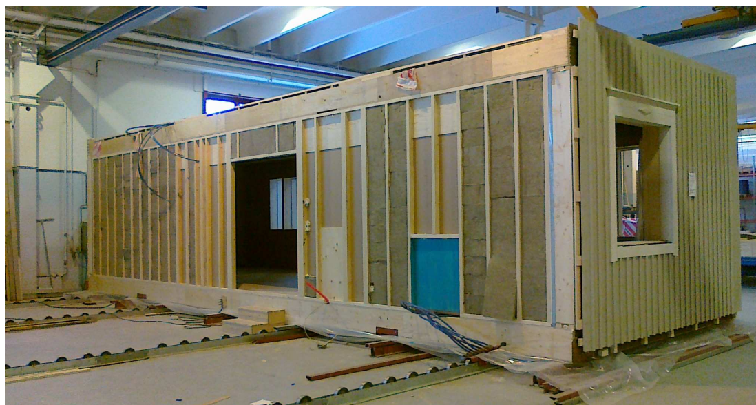
Bild 3. Bild av en modul som är färdigt monterad och klar för inredning.
