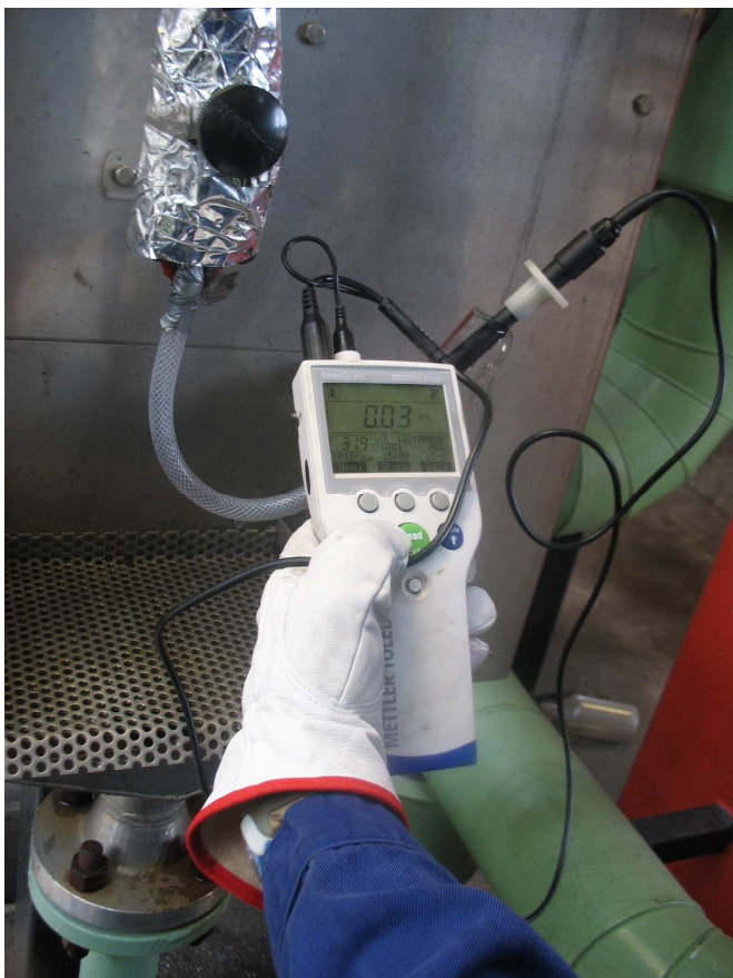
Kuva 12: 15.5.2011 klo 13:15 suoritettu kattilaveden happipitoisuusmittaus SG 6 anturilla.
