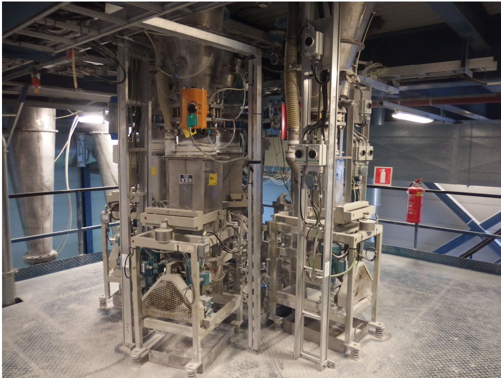
Kuva 8. B-linjaston vanhan puolen vaa'at ja niiden sijoittelu pelletointirakennuksessa
