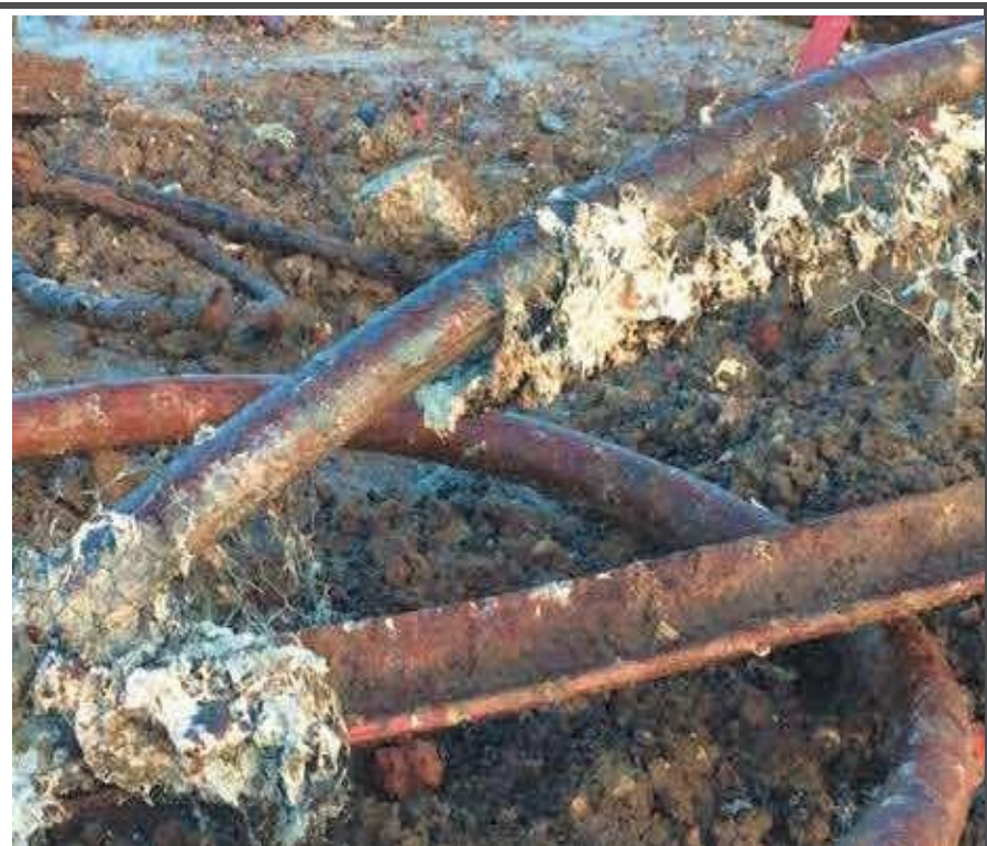
Kuva 26. Lähikuva jäljellejääneestä asbestista tehdystä lämpöeristeput- kesta. (Soilfix Limited).
