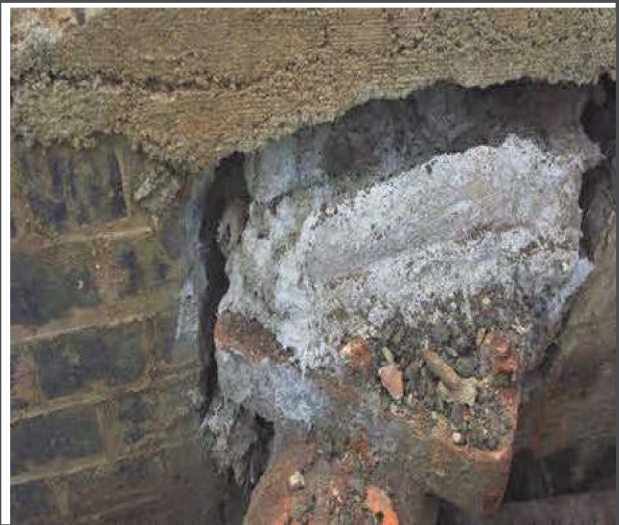
Kuva 32. Erittäin vahingoittunut/hajonnutta asbestieristettä putken pinnalla maanalaisessa kanavassa. (Hydrock).
