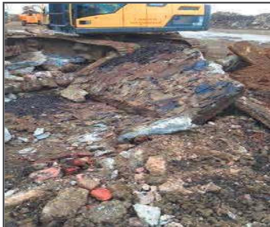
Kuva 8. Erinomainen esimerkki koskemattomasta asbestisementtijätteestä, joka paljastui betonilaatan alapuolelta. (Soilfix Limited).
