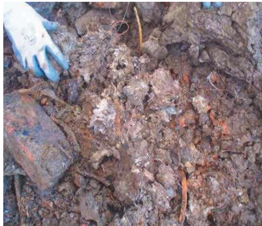
Kuva 34. Erittäin vahingoittunutta/hajonnutta asbestieristettä/kuitujätettä ylöskaivetussa täyttömaassa. (Hydrock).
