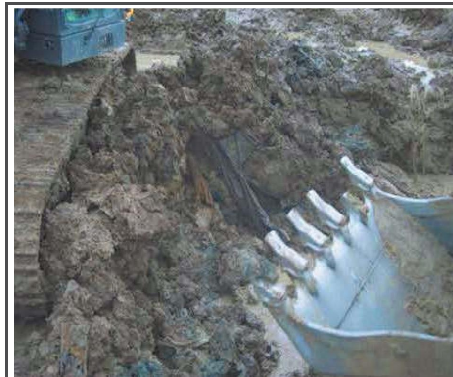
Kuva 18. Rapautunutta asbestitekstiilihuopaa ylöskaivetussa täyttömaassa. (Hydrock).
