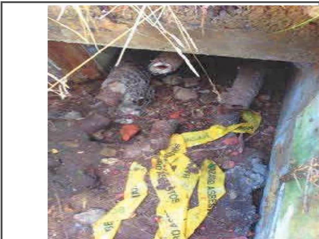
Kuva 27. Lähikuva jäljellejääneestä asbestista tehdystä lämpöeristeputkesta maan- alaisessa kanavassa. (Soilfix Limited).
