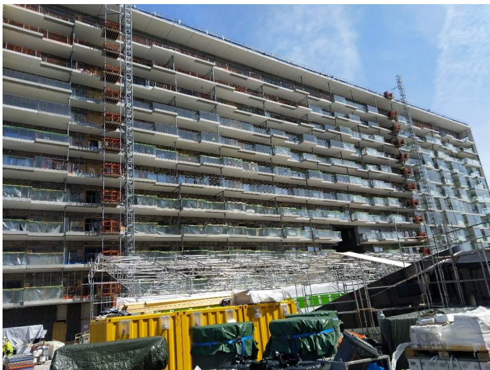
Kuva 7. Sisälogistiikka pyörii pääasiassa kohteessa tavarahisseillä, jolloin työntekijät pystyvät käyttämään varsinaisia porrashissejä, tavarantoimittajien hyödyntäessä julkisivulla olevia tavarahissejä. (Tuunainen, 29.5.2019)
