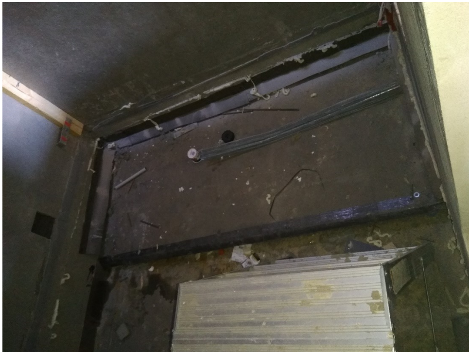
Kuva 3. Tekniikkakuiluun asennettu seinien ympäri kolmiorimat ja huopa, jotta vesi ei pääse alimpiin kerrokseen keskeyttämään sisätyövaiheita. Alimmassa kohdassa väliaikainen sadevesikaivo. (Tuunainen, 8.6.2018)
