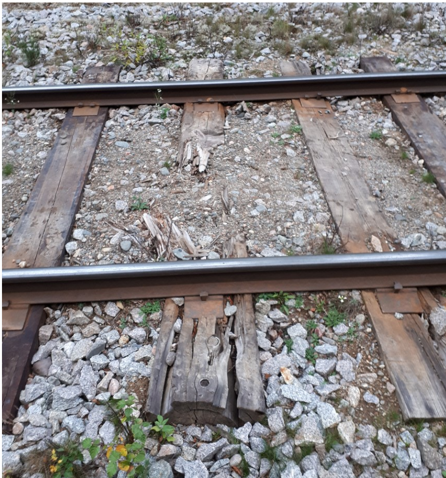
KUVA 7. Erittäin huonokuntoinen puinen ratapölkky ja pilaantunut tukikerros
