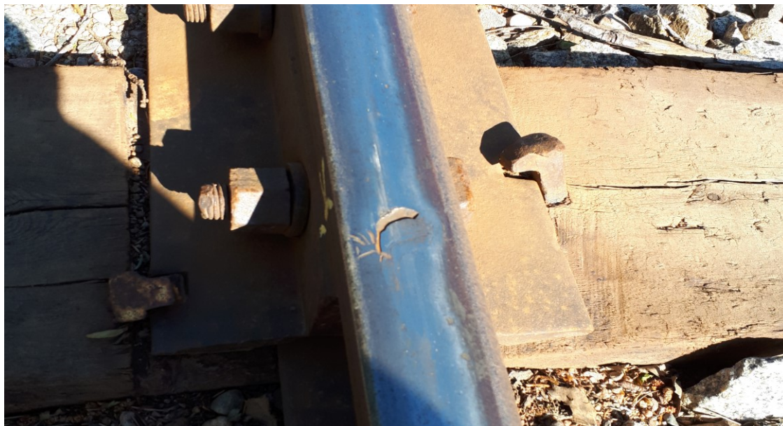
KUVA 5. Ympärilyönnin aiheuttamaa kiskon kuluneisuutta
