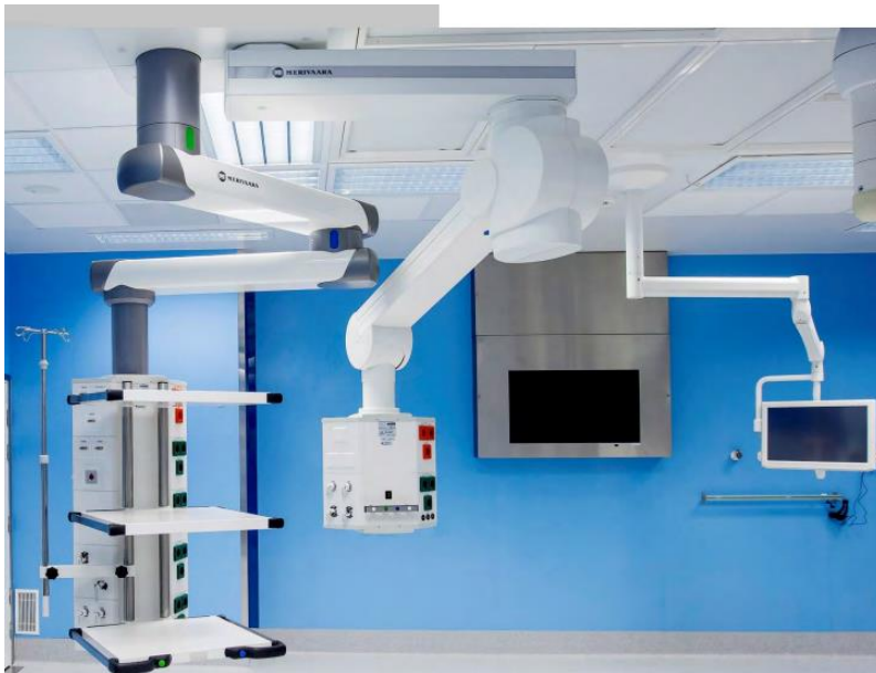
Kuva 19. Erilaisia kattokeskusmoduuleja [34, s. 44].
