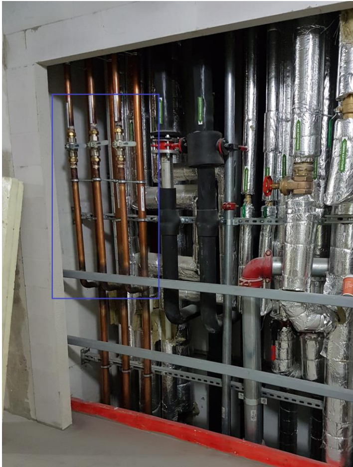
Kuva 16. Kerroskohtaiset pääsulkuventtiilit tekniikkakuilussa [19].
