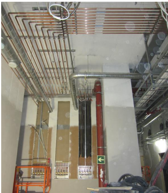
Kuva 9. Sairaalakaasuputkistoa ja pikasulkukoteloita asennuksen ollessa vielä kesken [19].
