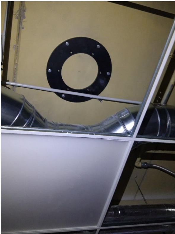
Kuva 8. lv-kanavan, valaisimen ja tutkimusvalaisimen yhteentörmäys.
