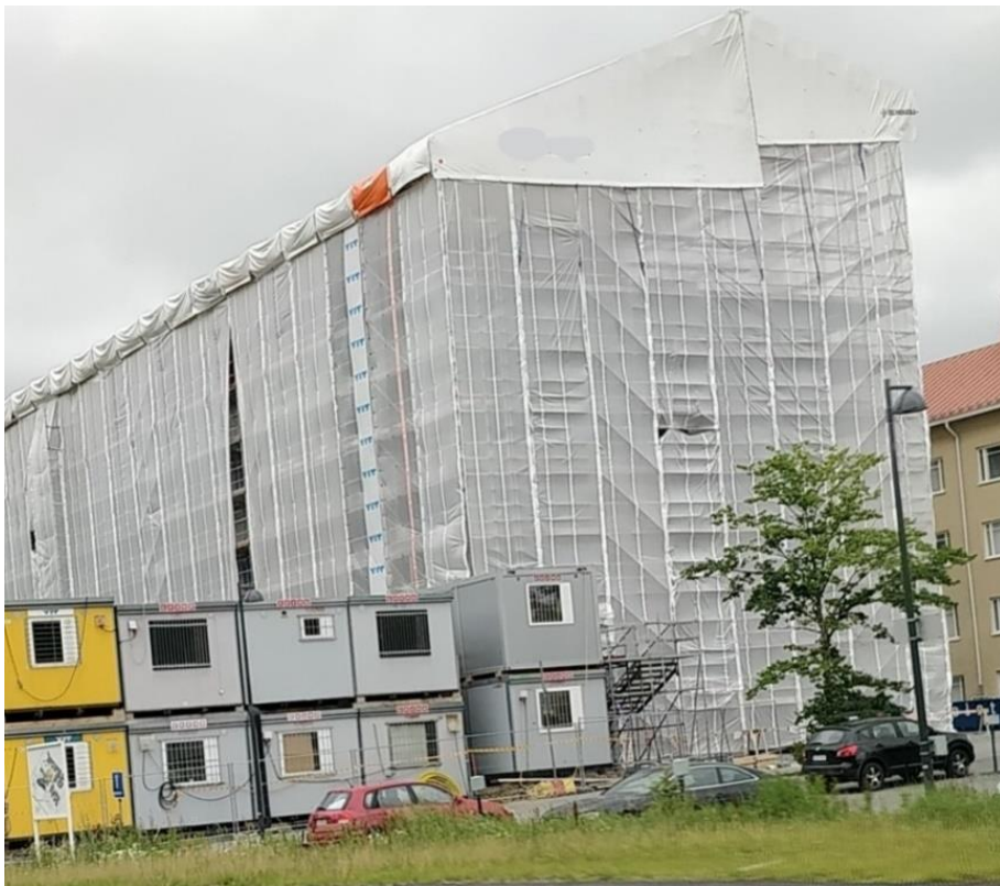
Kuva 6. Rakennusta suojaava sääsuoja.
