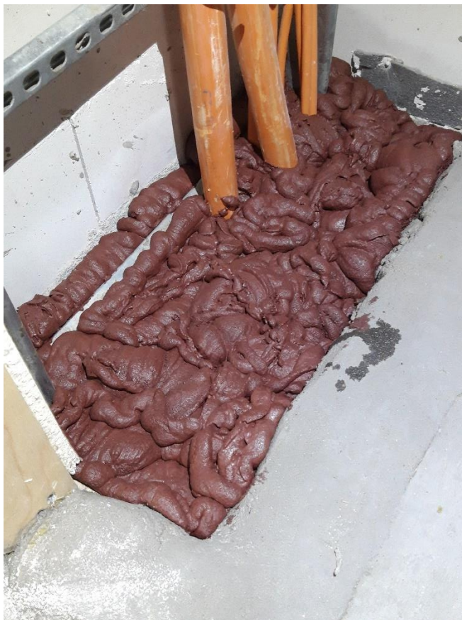
Kuva 4. Kerrosten välinen palokatko, palovilla ja vahto.
