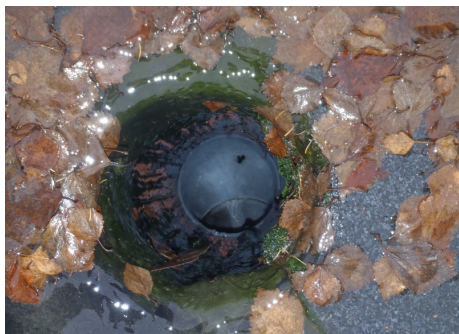
Kuva 5. Tukkeutunut kattokaivo (Hometalkoot 2019).
