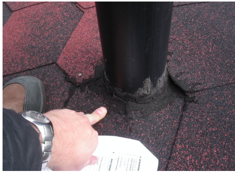
Kuva 4. Vanha läpiviennin tiivistys (Hometalkoot 2019).
