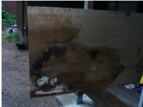
Kuva 6. Vuotokohdan alla ollut levy (Hometalkoot 2019).
