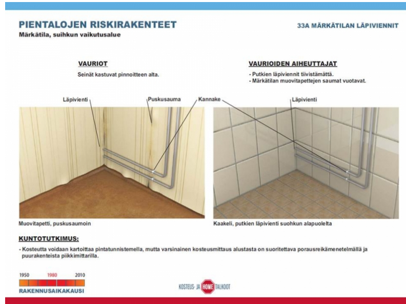
Kuva 8. Läpivientien tiivistyksen puutteet (Hometalkoot 2019).
