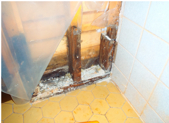
Kuva 7. Seinän rakenne rikkoutuneen muovimaton takana (Hometalkoot 2019).
