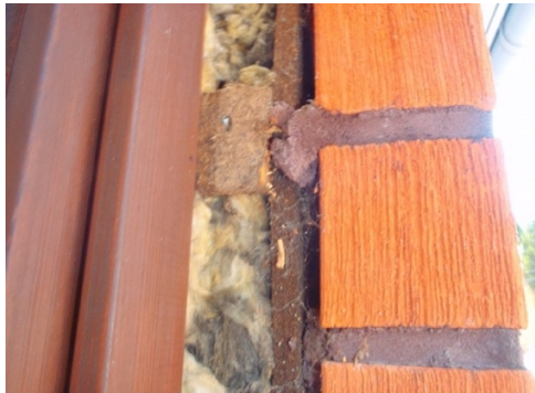
Kuva 2. Tukkeutunut tuuletusrako (Hometalkoot 2019).
