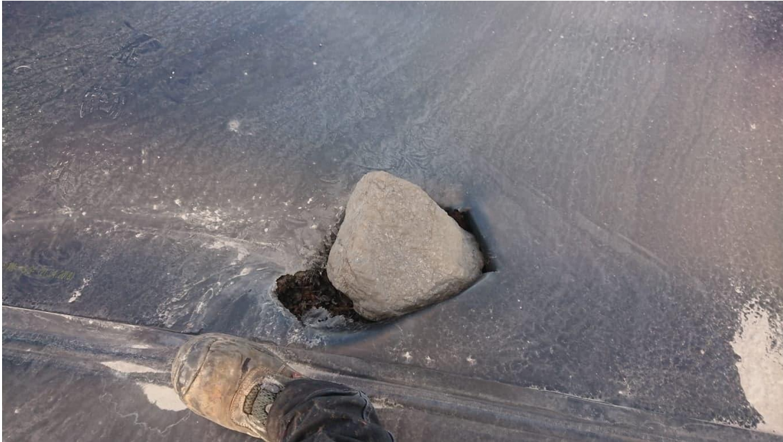
KUVA 2. ”Ampukivi,” joka on lävistänyt suojaamattoman geomembraanin.
