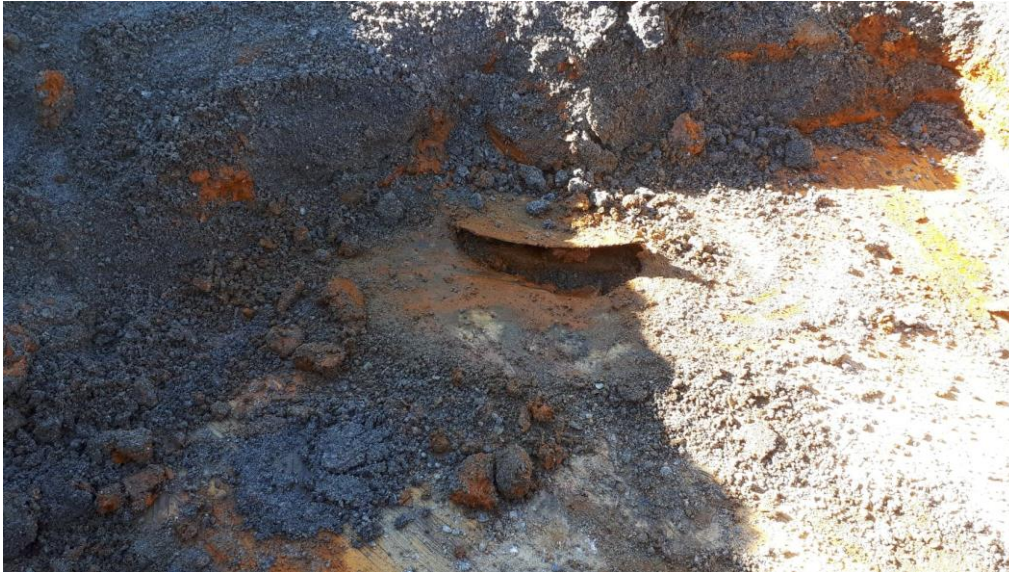
KUVA 5. Vaurioitunut geomembraani, joka on löytynyt sakasta ja kivituhkasta muodostuneen 300 mm:n paksun peiterakenteen alta.
