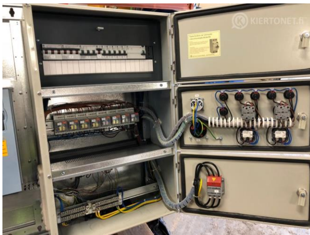
Kuva 25. Kaapelointi ovikojeilta. (Kiertonet, 2020)
