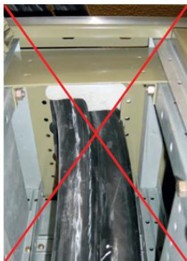
Kuva 10. Kaapelin eriste on vaurioitunut. (Mäkinen & Koivisto 2020, s. 44.)
