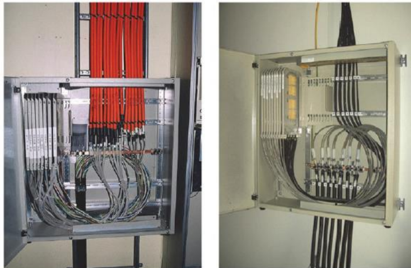
Kuva 21. Koteloasennus. (Mäkinen & Koivisto, 2020 s. 209)
