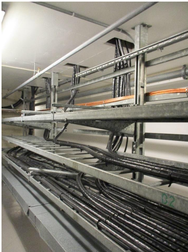
Kuva 23. Hyvin toteutettu kaapelointi.
