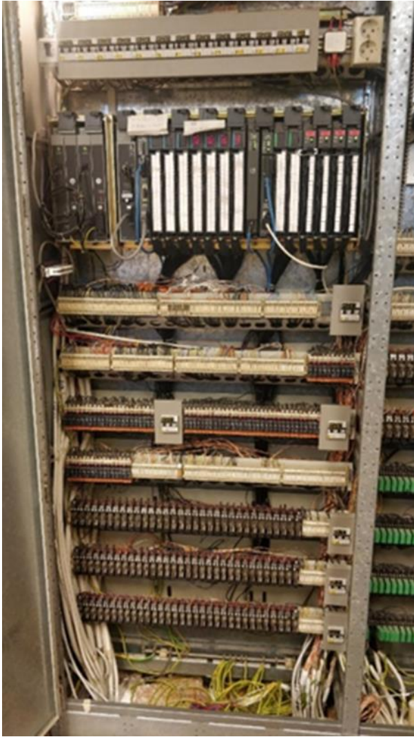
KUVA 22. Merikosken voimalaitoksen Allen-Bradley ala-asema KK1
