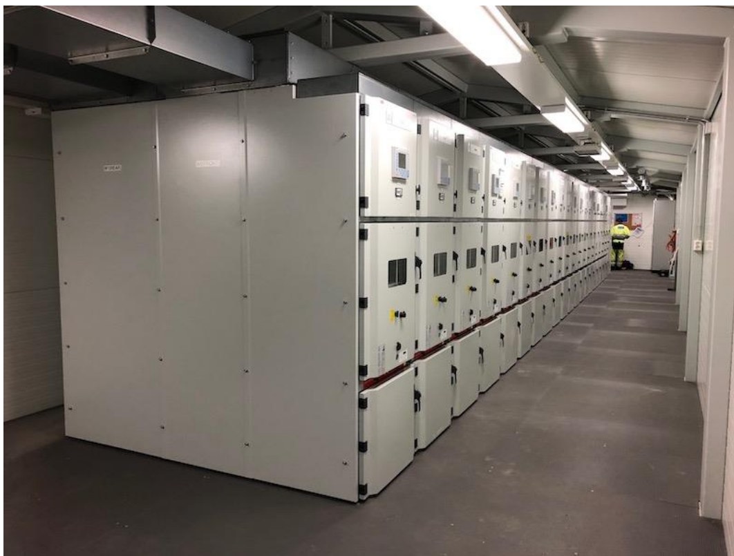
Kuva 12. ABB UniGear-keskijännitekojeisto Vaasan Sähkön sähköasemalla.
