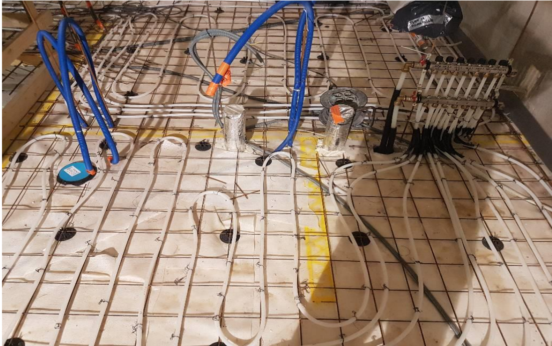
Kuva 2. Nuottaniemen yläkerran lattialämmitysputkisto
