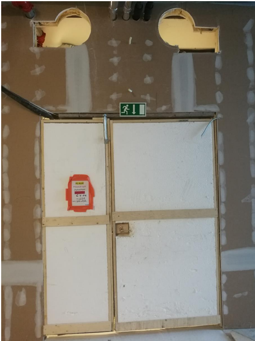
Kuva 11. Reikien suojaukset puuttuivat.
