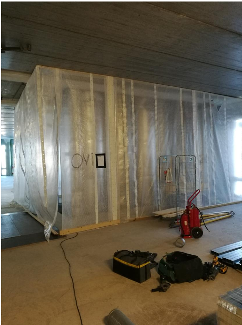
Kuva 4. Ilmastointikuilu osastoitu muoviseinillä.
