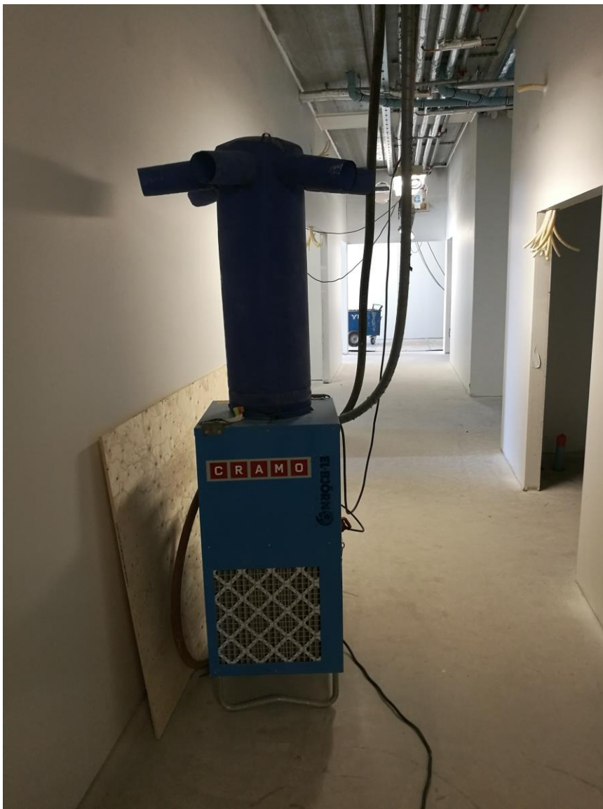
Kuva 12. Lämpöpuhallin osastoidulla alueella.
