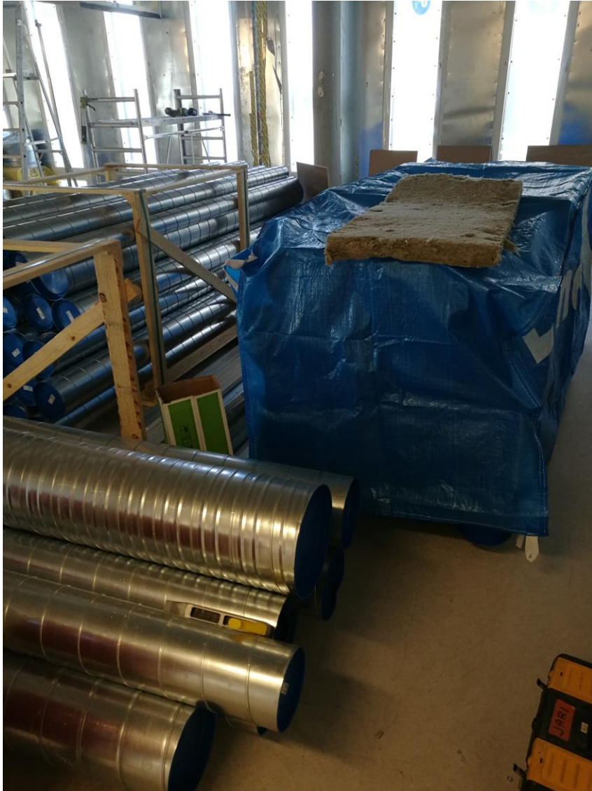
Kuva 15. Villa säilytettiin väärin ilmastointikanavien läheisyydessä.
