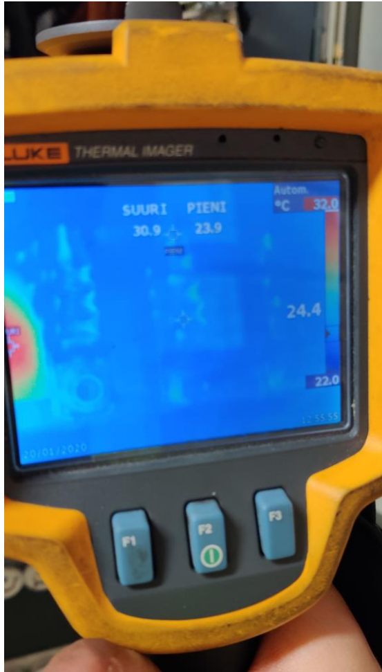
Kuva 17. Sähkökeskuksen A31 syöttöjohtimet
