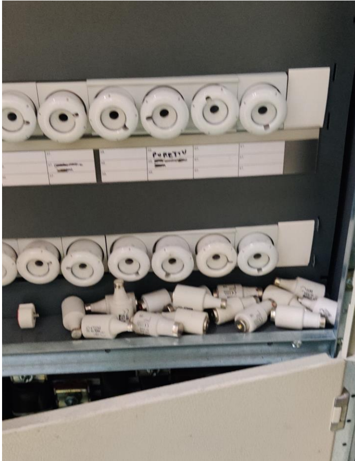
Kuva 12. Sähkökeskuksen sisällä säilötyt sulakkeet
