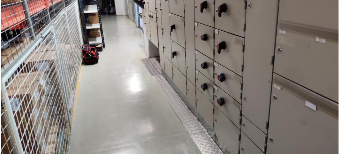
Kuva 8. Sähkökeskusten A31 ja B31 edusta.
