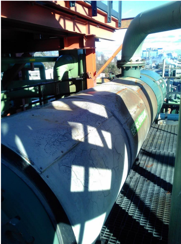
Kuva 6: EA-162 lämmönvaihtimen eristys
