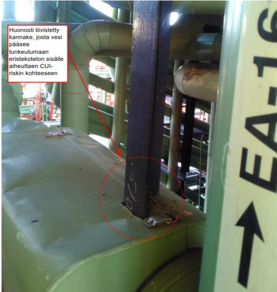
Kuva 3: Huonosti tiivistetty kannake eristetyssä putkilinjassa
