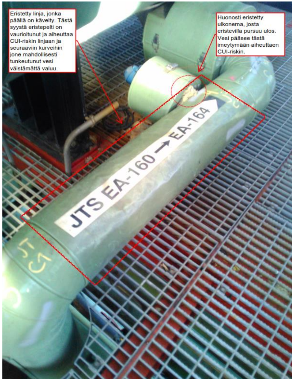
Kuva 4: Vaurioitunut eristetty putkilinja
