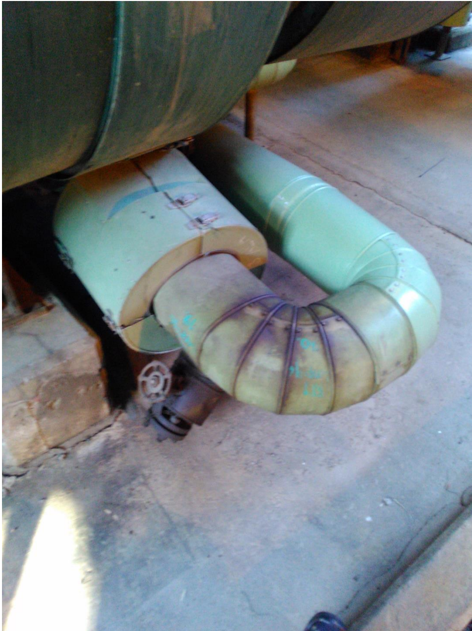
Kuva 7: EA-163 lämmönvaihtimen tyhjennys huonossa kunnossa
