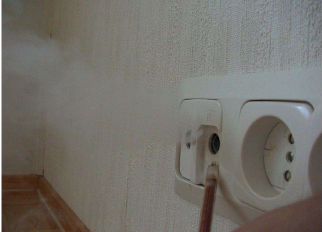
Kuva 9. Korvausilmaventtiin puutteen takia antennirasia toimii venttiilinä. (Hengitysliitto, 2020.)
