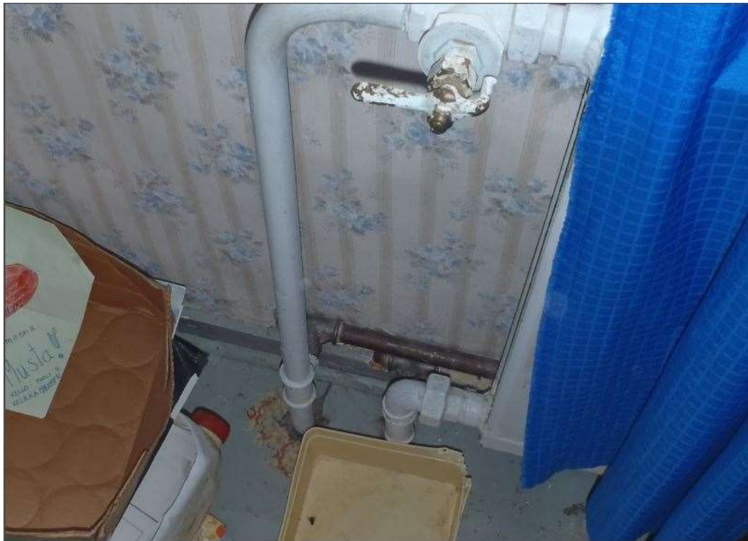
Kuva 8. Muoviastia vuotavan patteriventtiin alla (Hengitysliitto 2020.)
