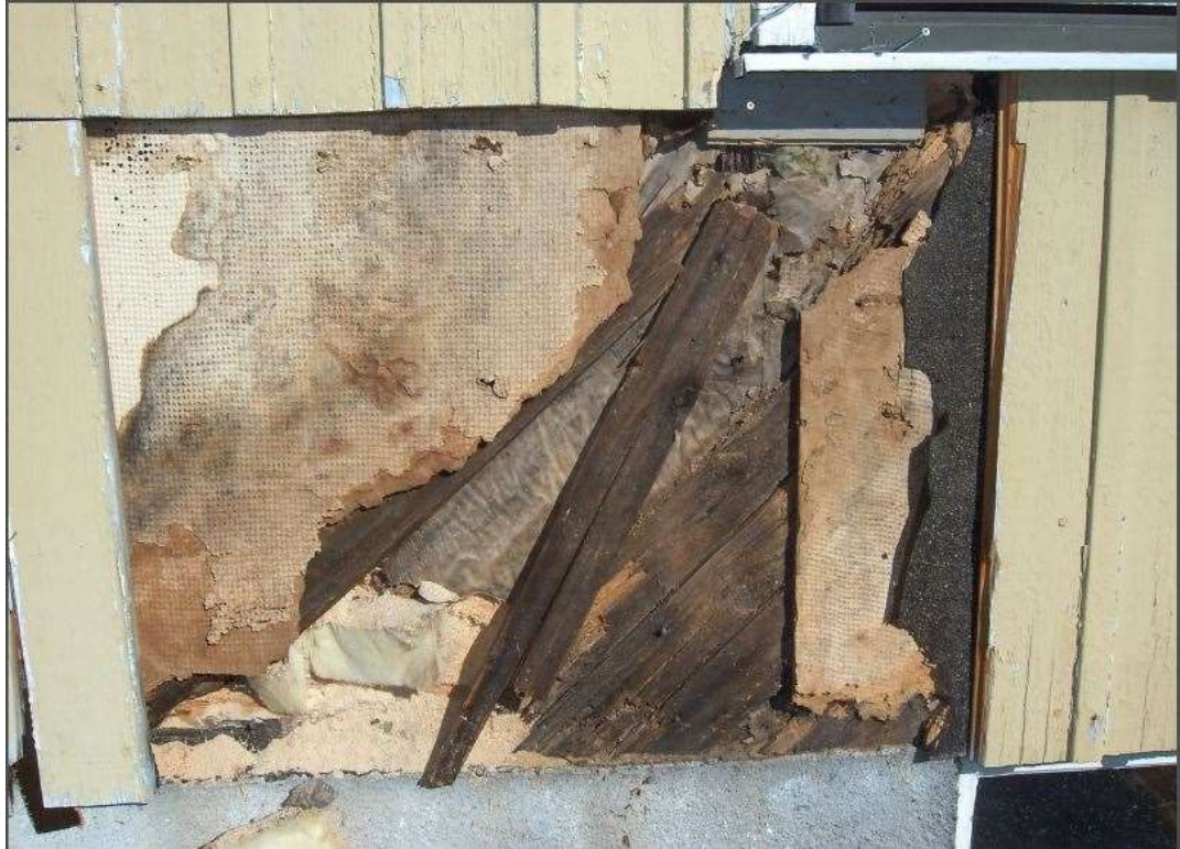
Kuva 6. Epäonnistuneen ikkunapellityksen aiheuttama kosteusvaurio ikkunan alapuolisessa seinärakenteessa. (Hengitysliitto, 2020.)
