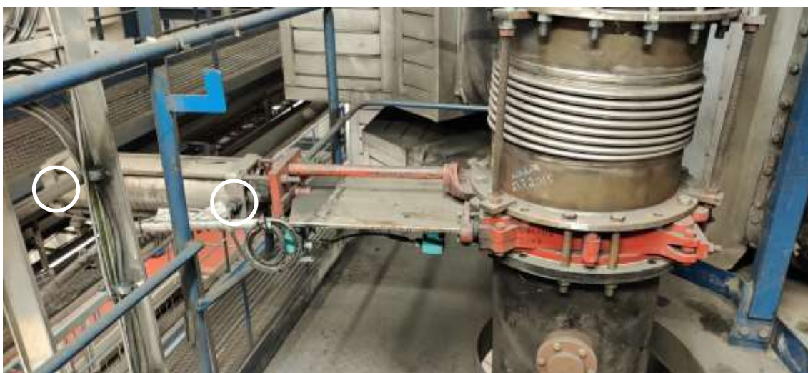
Kuva 16. Hiilipölyn sulkupelti ja paineilmasylinteri.
