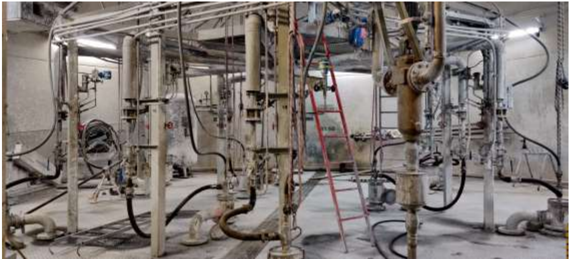
Kuva 5. SaRi reaktori 1: kalkinsumutuslaitteet.
