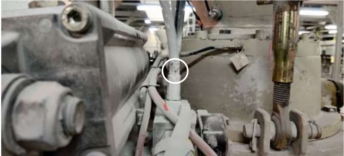
Kuva 17. Reikä paineilmakäyttöisen sylinterin letkussa rikinpoistolaitoksen pöyläohjaimessa.
