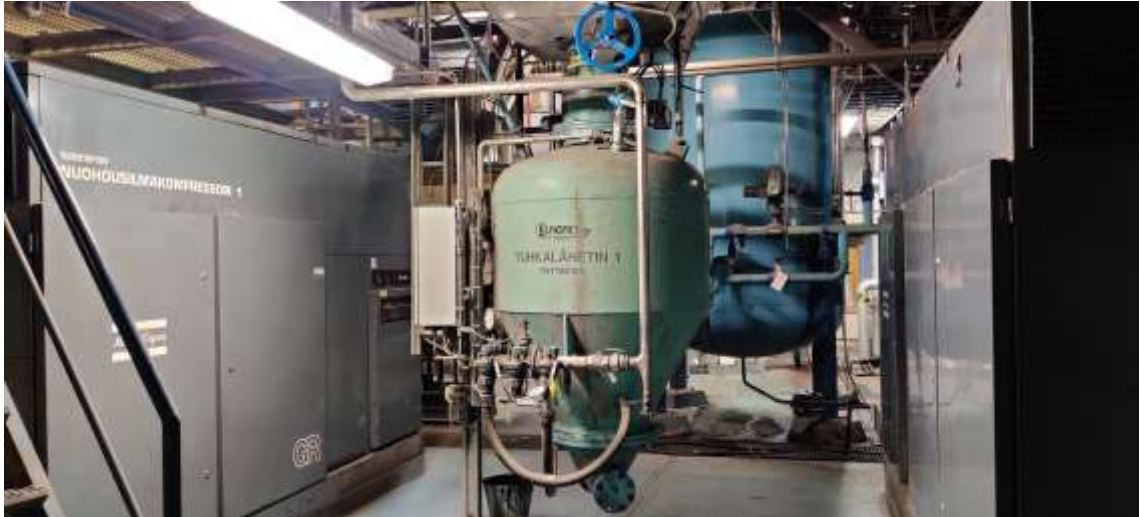
Kuva 6. Yksi SaA-voimalaitoksen viidestä tuhkalähetimestä.
