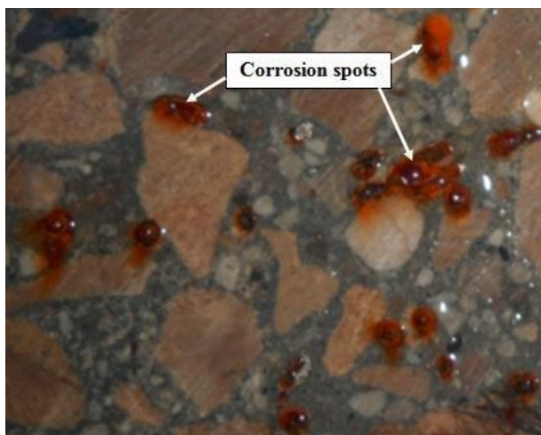
Kuva 21. Pintaruoste teräskuitubetonilaatan pinnalla.
