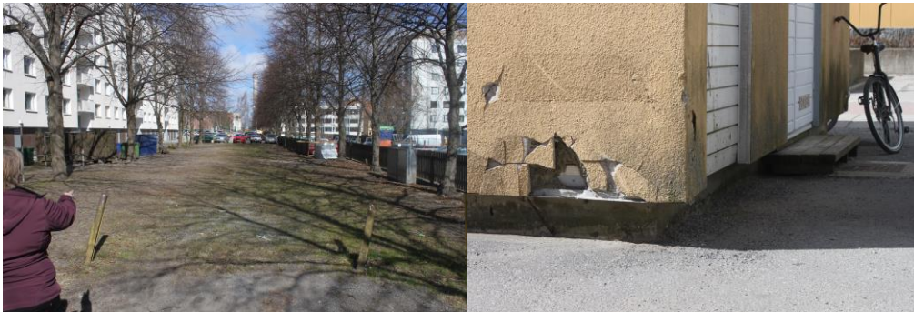
KUVIO 12. Kuvat Esteettömyysprojektista, palokatua vuonna 2017 ja poistettavaksi esitetyn entisen kioskin huono kunto (Esteettömyysprojekti 2, kokousmuistio 13.6.2017).
