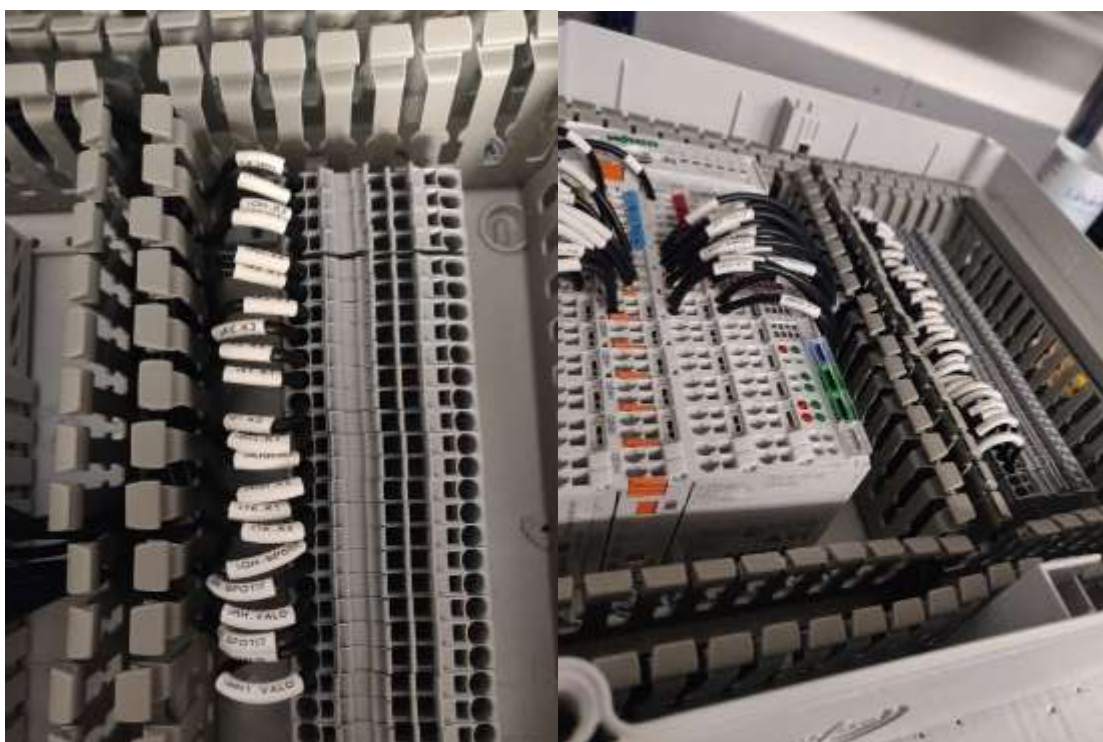
Kuvat 18. Moduuleiden johdotusta
