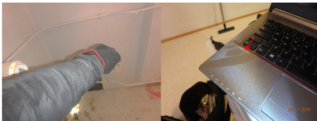
KUVA 40. ja KUVA 41. Vasemman puoleisessa kuvassa tutkijan vaateista rakenneavauksen jälkeen, hengitysvyöhykkeen altistumisriski on selvä. Oikean puoleisessa kuvassa silmämääräistä pölykertymää tason päällä olevan tietokoneen päältä. (Meriläinen 2019)
