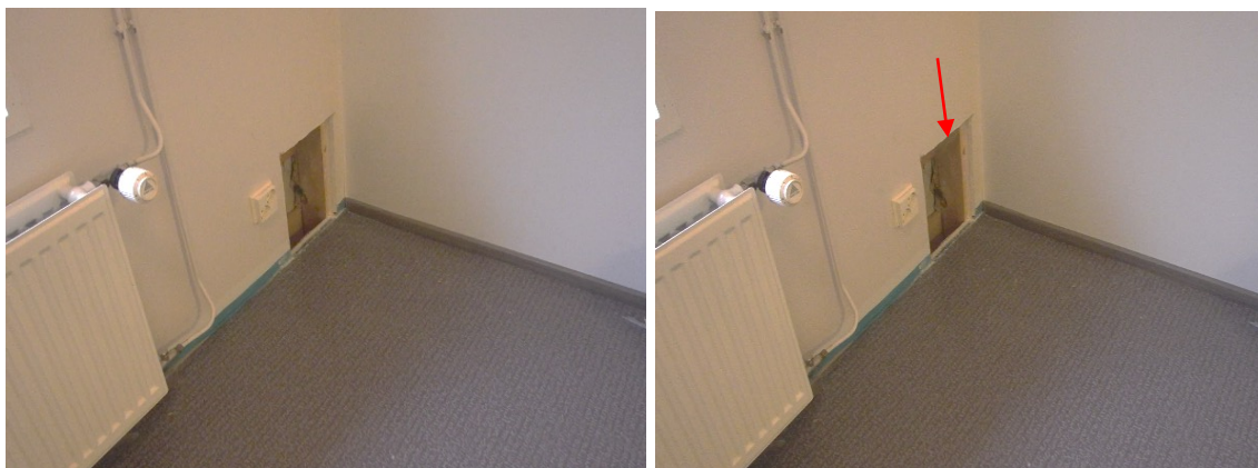
KUVA 36. ja KUVA 37. Vasemman puoleisessa kuvassa tilanne n. +5 Pa ylipaineessa, viitteitä ilmavirroista sisälle ei ole. Oikeanpuoleisessa kuvassa merkkisavua vähäisesti näkyvillä rakennauskohdan yläreunassa ulko-ovea raollaan käytettäessä. (Meriläinen 2019)
