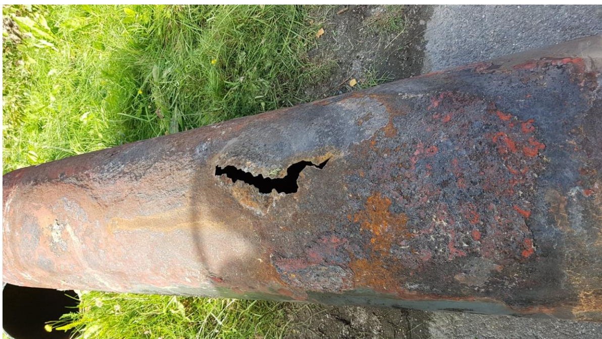
Bild 11: Bilden tagen från Werner Söderströms gatans läcka 2019.
