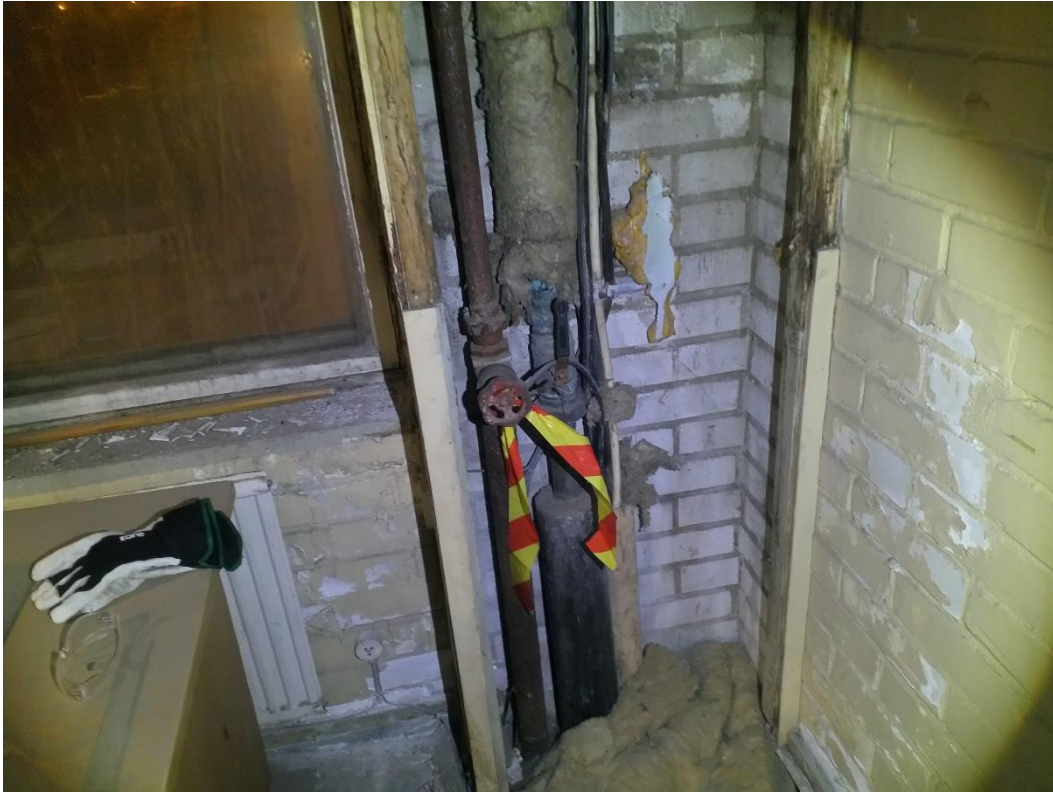
Läckande ventil, tvätthallen.
