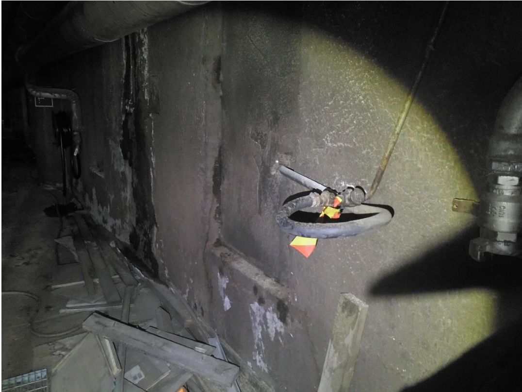
Läckande ventil, ovanför flissilo 1-6.
