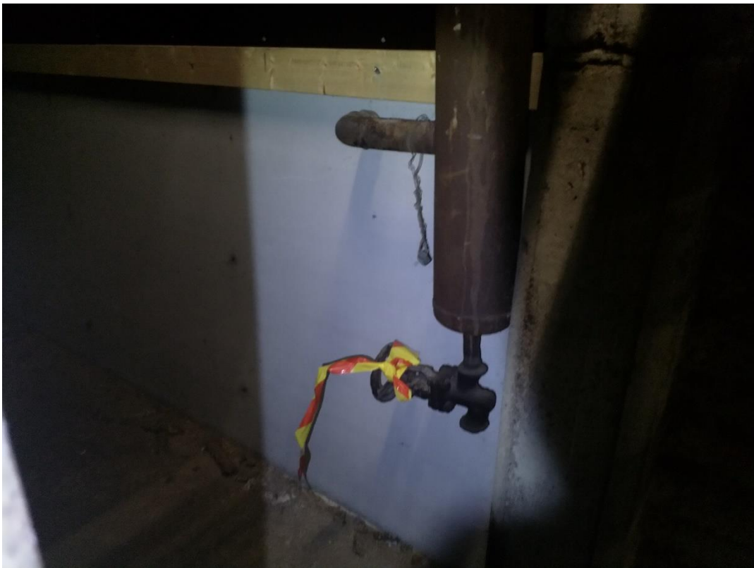
Läckande ventil, flissilo 1-6.
