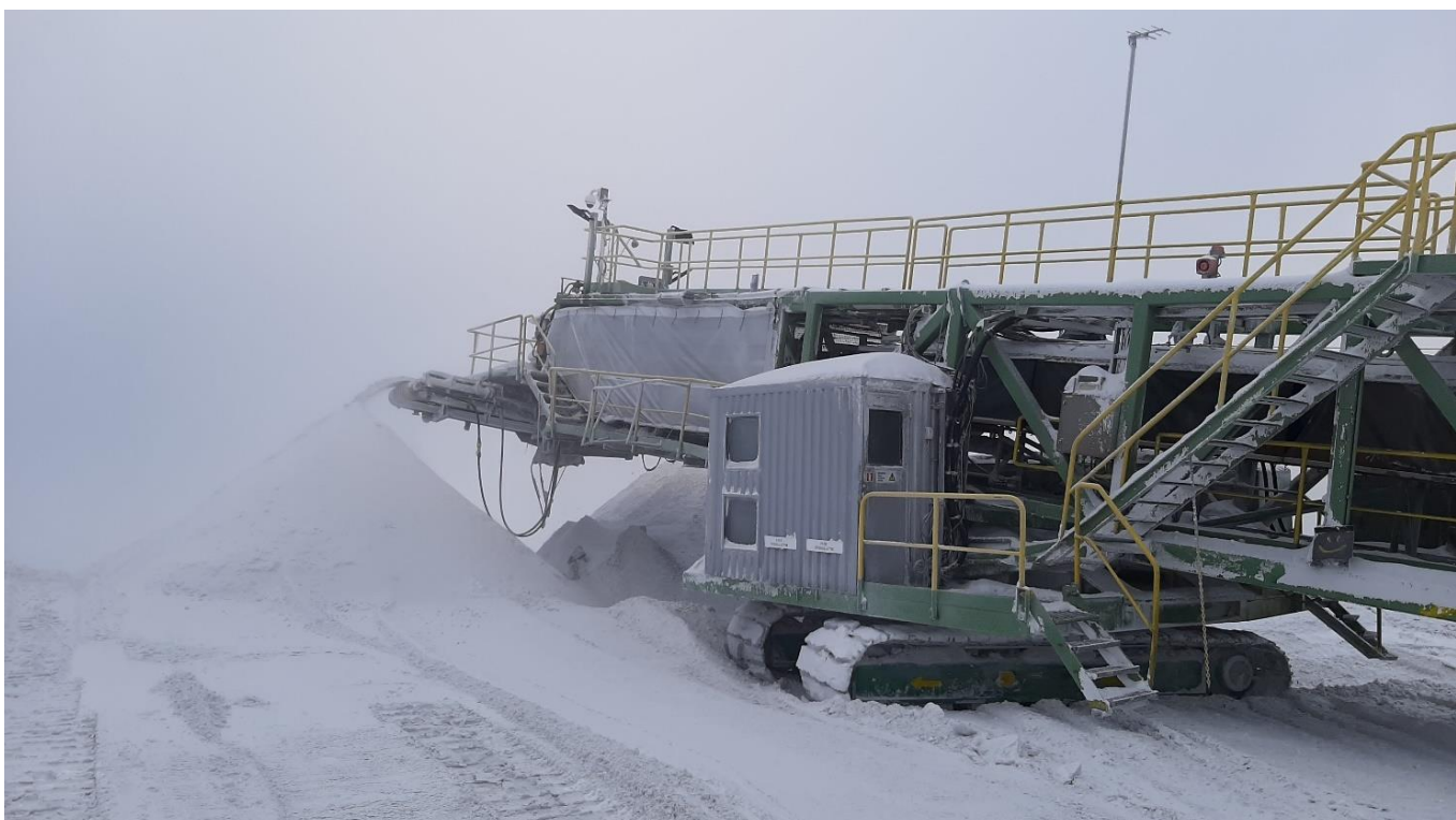
Kuva 9, Roxonin pudotuspää. Kuvassa myös sähkökeskus, ajotelat ja heittokuljetin (Hartikainen, 2020)
