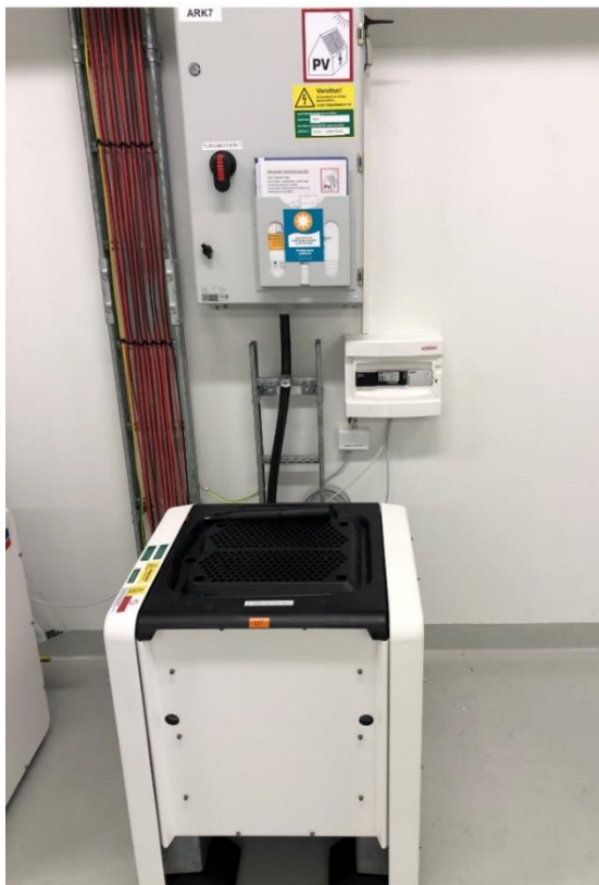
KUVA 4. SMA core1 vaihtosuuntaajan ympäristö on siisti ja tilava, mikä takaa optimaalisen toiminnan (4).
