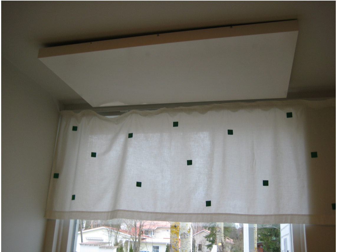
Kuva 4. Friisilän päiväkodin aulatilán ikkuna ja kattolämmityselementti.
