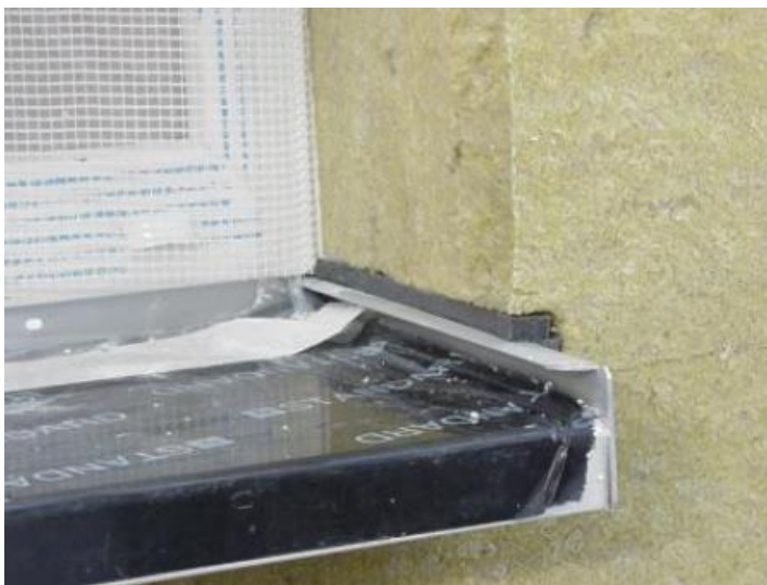
Kuva 24. Ikkunan vesipelti rappausreunalla (Maalarimestarien.fi)
