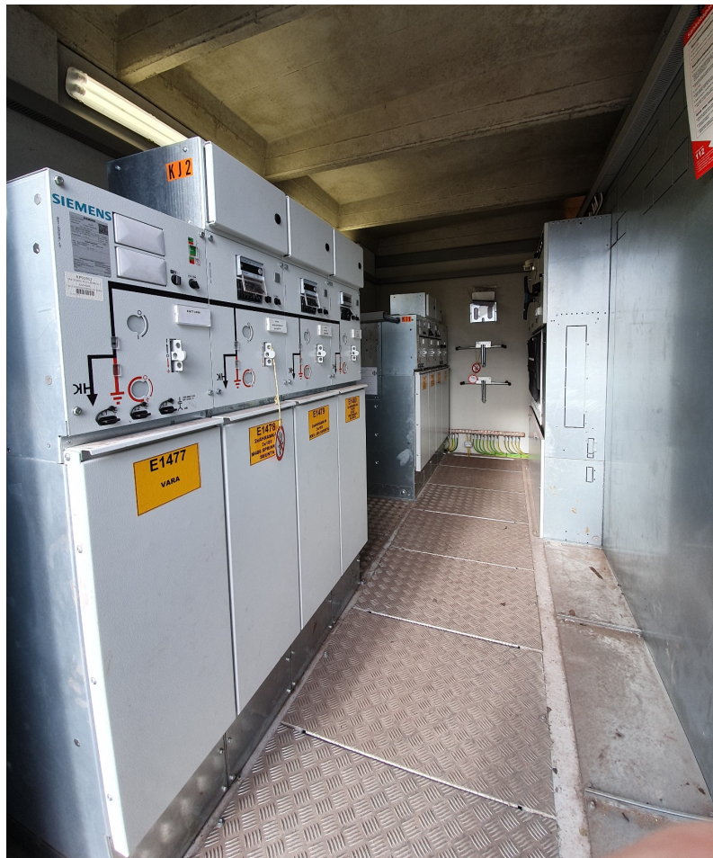
Kuva 5. Kokkolan Sataman alueella sijaitseva erotin- ja muuntamo.
