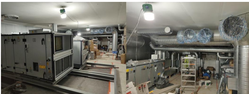
Kuva 10. Konehuone ja IV-kanavien suojaukset.
