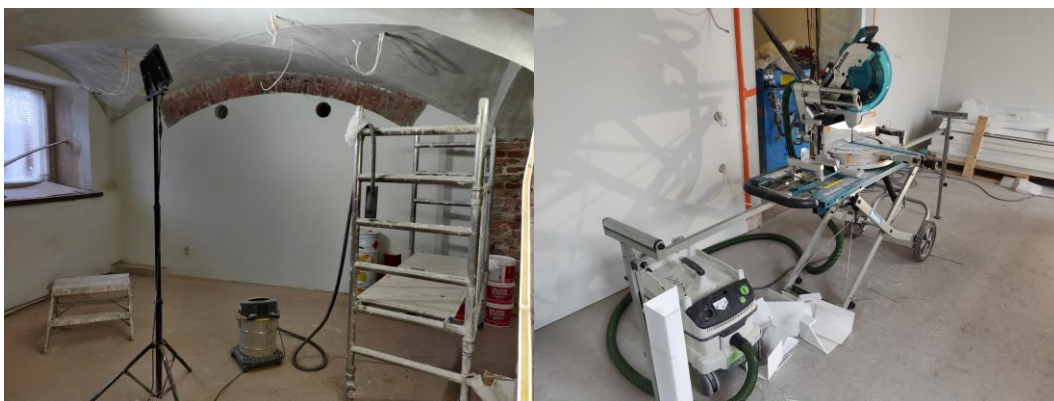
Kuva 6. Kohdepoistolaite liitettynä hiomakoneeseen ja pöytäsiirkeliin.
