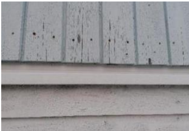
Kuva 28. Pystypaneloinnissa on osittain lahovaurioita.
