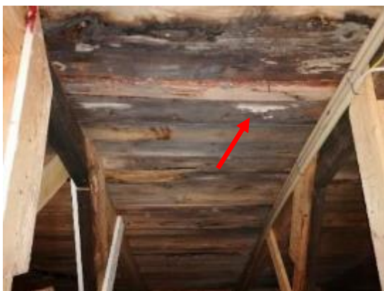
Kuva 36. Vesikaton vanha vuotokohta, jossa on merkkejä mikrobivauriosta.
