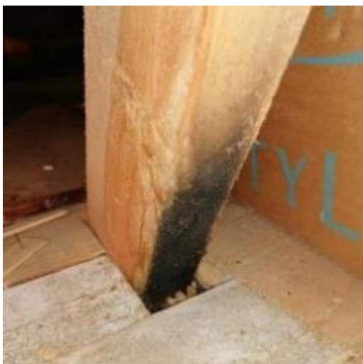
Kuva 42. Kattotuolin diagonaalinen tummunut alareuna.
