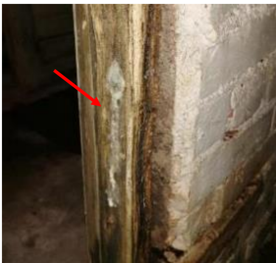
Kuva 24. Ovenkarmissa on mikrobikasvustoa.
