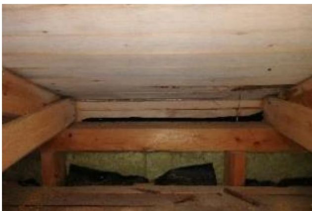
Kuva 40. Räystääslinjoilla ei ole korvausilmareittiä.
