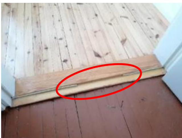
Kuva 52. Kuvassa 50 näkyvän oven ilmavuodon aiheutti puuttunut tiiviste.
