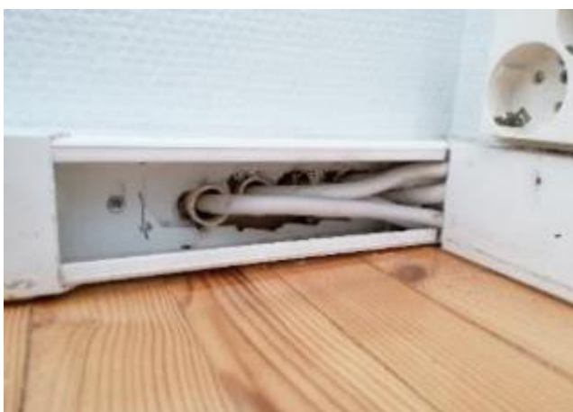
Kuva 51. Kuvassa 50 näkyvän nurkan tiivistämättä jääneet läpiviennit.
