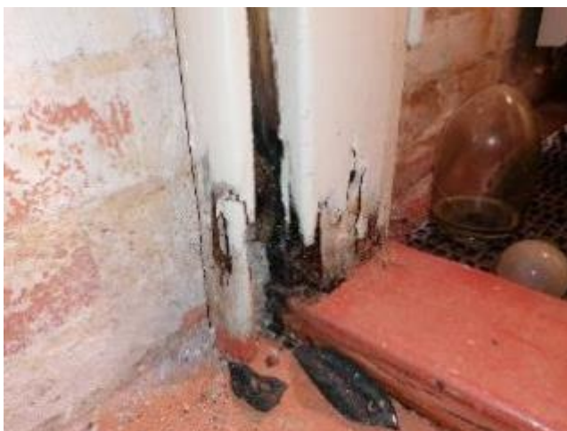
Kuva 18. Välioven kynnyksen ja karmin lahovaurio.
