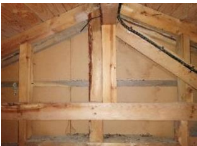
Kuva 39. Ullakkotilan päätykolmioissa ei ole tuuletusaukkoja.
