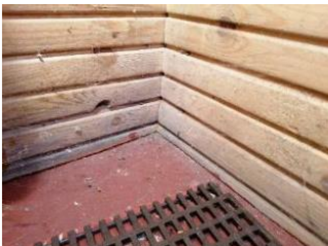
Kuva 17. Pukuhuoneen panelointi on kiinni lattian pinnassa.
