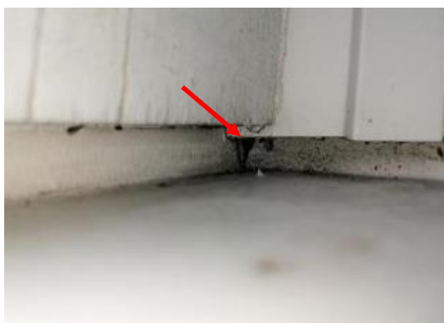
Kuva 30. Ikkunoiden vesipeltien nurkissa on reiät.
