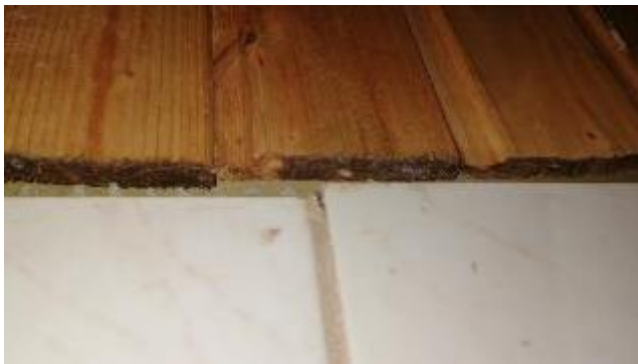
Kuva 32. Saunan paneloinnin takaa puuttuu tuuletusrako.
