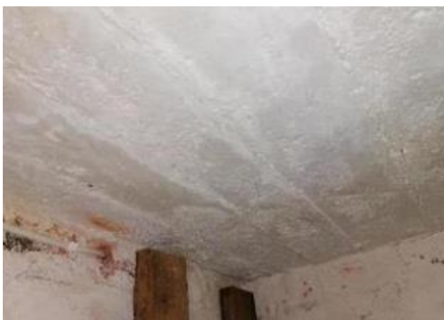
Kuva 25. Katon betonilaatassa on kiteytynyttä suolaa.
