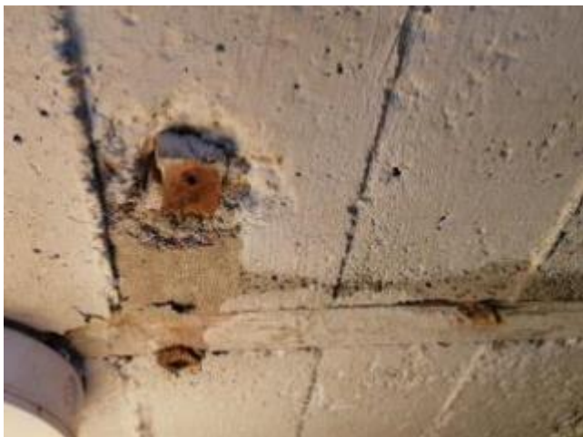
Kuva 15. Kellarin katon muottilautoja on betonin sisällä.
