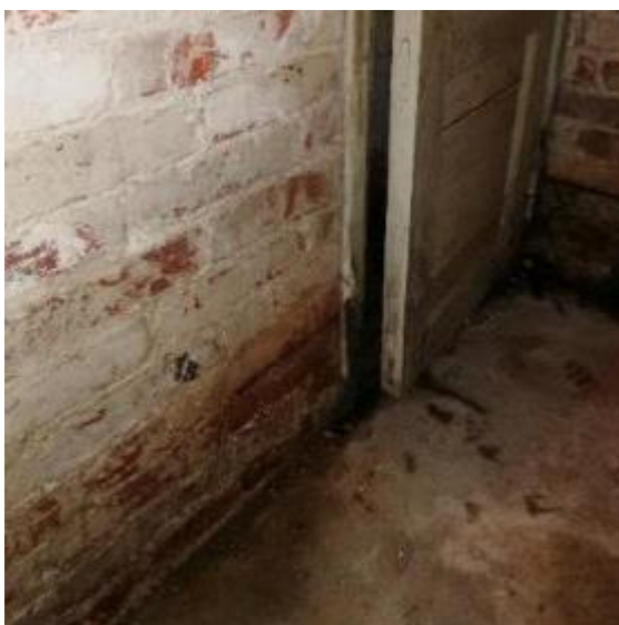
Kuva 23. Väliseinän ja lattian liitos on selvästi kostea.
