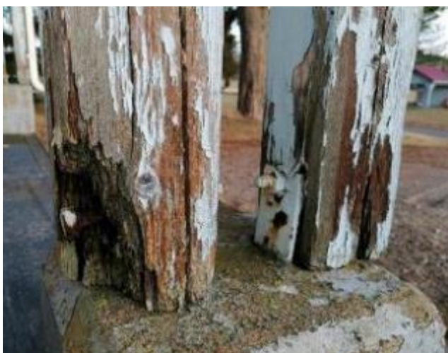
Kuva 10. Katoksen pilarit ovat voimakkaasti lahonneet.
