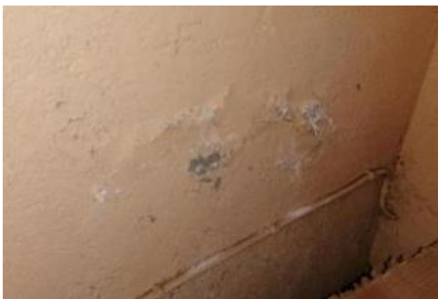
Kuva 14. Pesuhuoneen seinässä maalipinta on hilseillyt.
