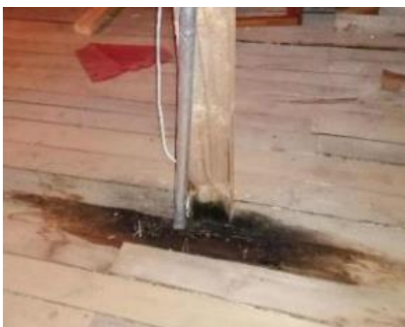
Kuva 37. Antennin kohdalla on vuoto.
