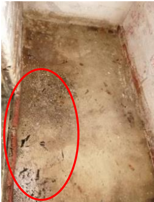
Kuva 21. Portaiden vierisessä varastossa on vettä lattian pinnalla.
