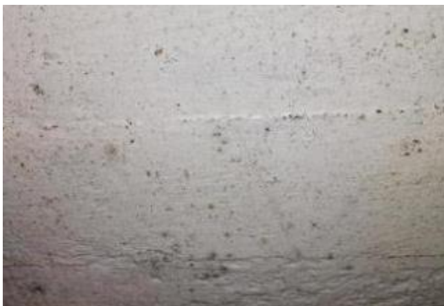
Kuva 16. Pesuhuoneen kattopinnassa on homepilkkuja.
