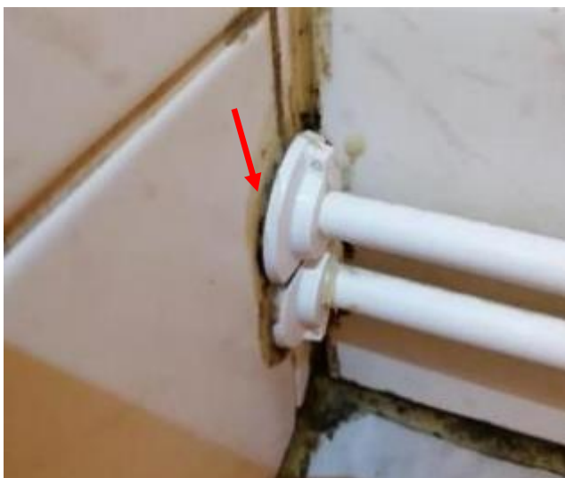
Kuva 33. Vesiputkien läpivienti ei ole tiivis.
