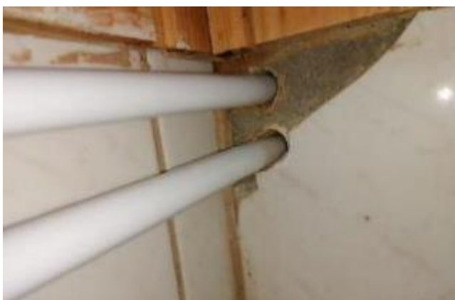
Kuva 34. Saunan puolella läpiviennissä on selviä puutteita ja laatta on lohjennut.
