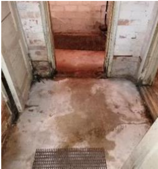
Kuva 20. Lattialla on selkeästi kosteita kohtia.
