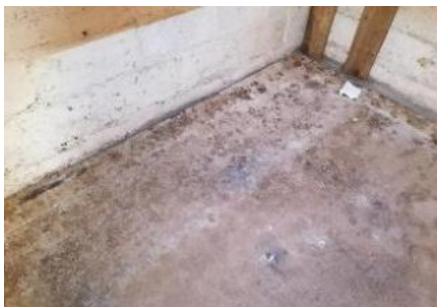
Kuva 11. Kellarin lattiaa peittävä pahvi.
