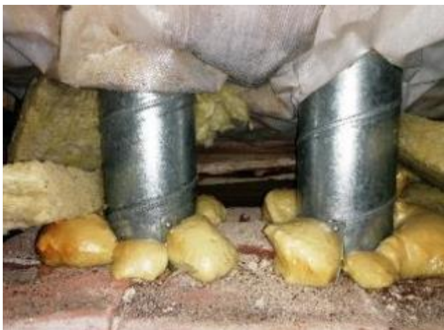
Kuva 41. Poistoilmaputket ovat yläpäästä eristämättä.
