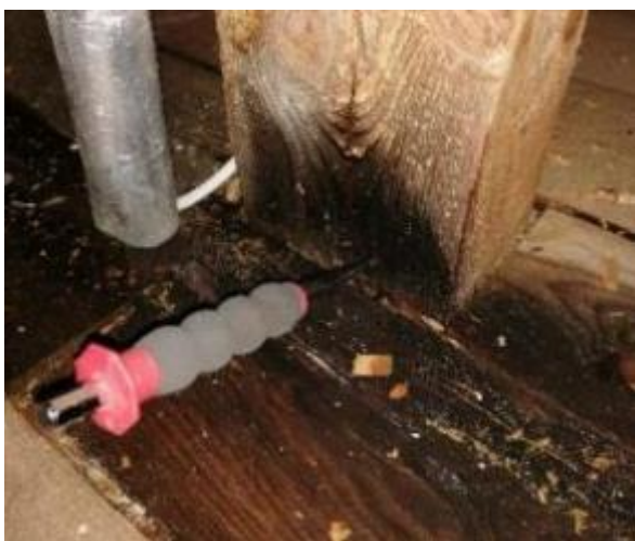
Kuva 38. Vuotokohdan pilarin piikkitesti.
