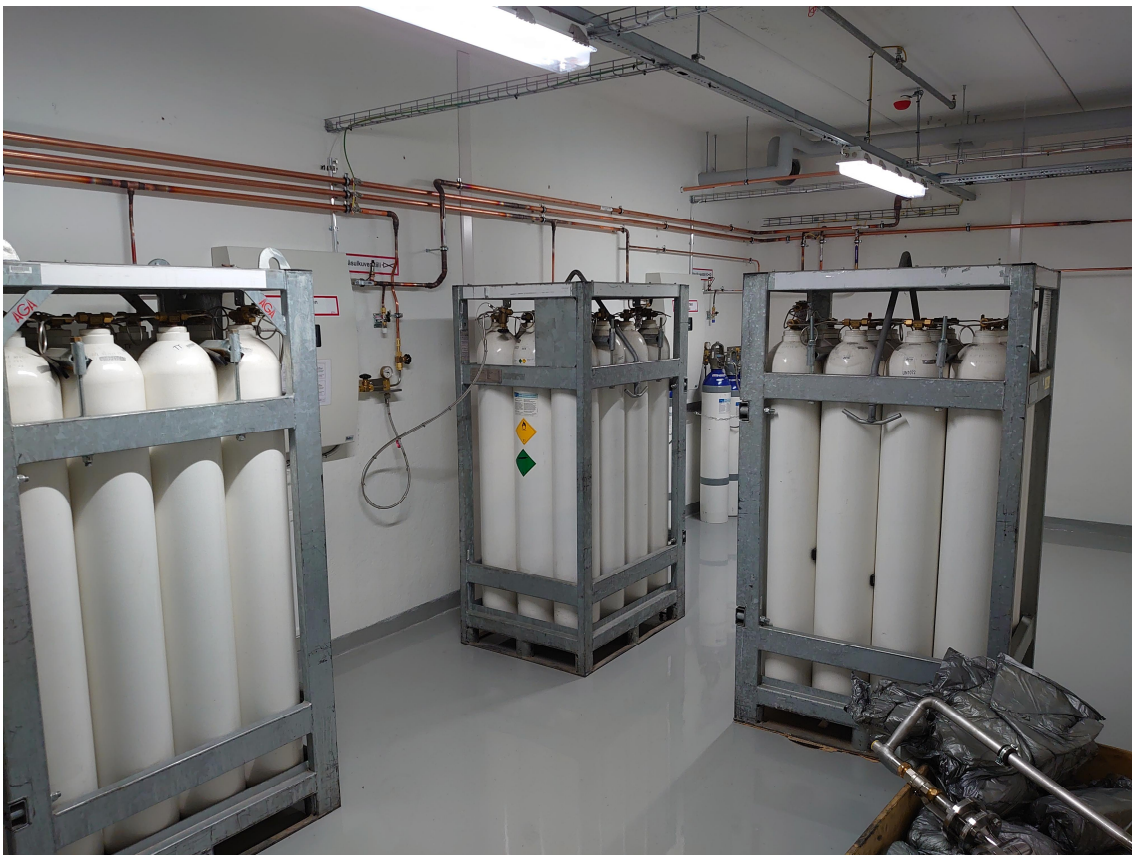
KUVA 8 Lääkkeellisen hapen pullopattereita kaasukeskushuoneessa
