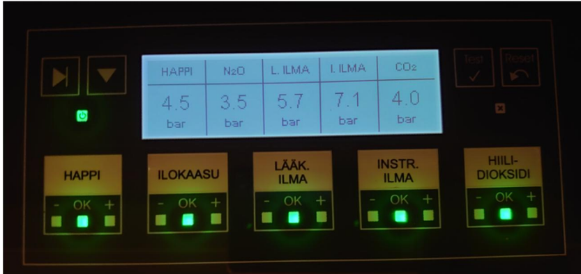
KUVA 6 Painemittaus pikasulkukotelon näytöltä
