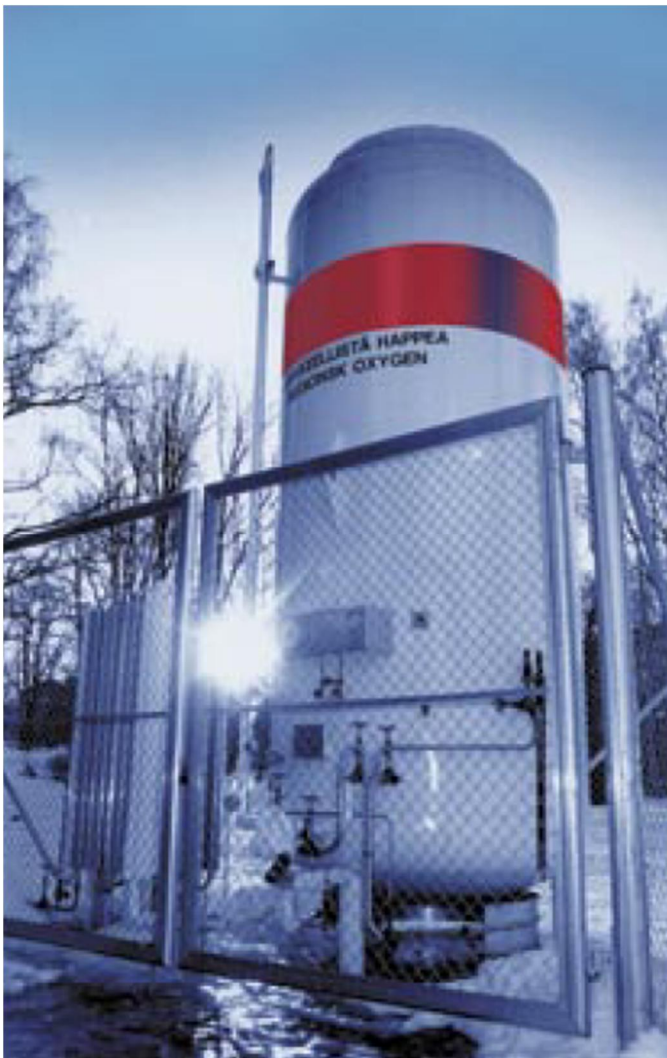
KUVA 12 Asianmukaisesti suojattu hapen nestesäiliöasema (3, s. 7)
