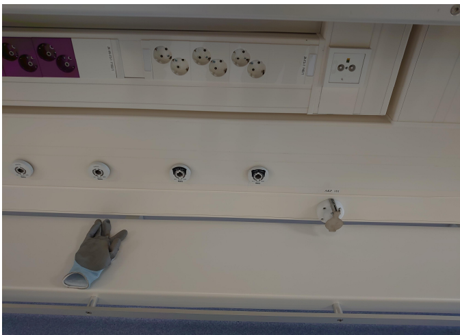
KUVA 27 Kouruasenteiset kaasunotto pisteet
