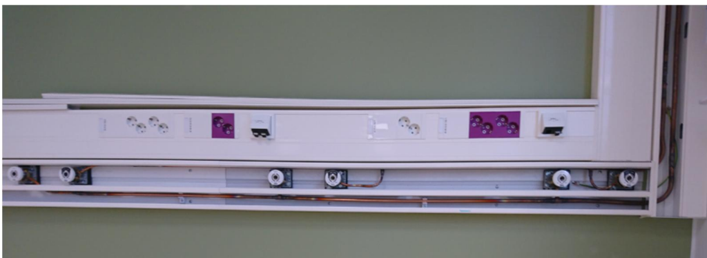
KUVA 28 Kaasunotto pisteet omassa kourussaan
