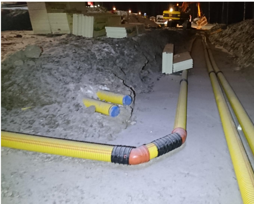
KUVA 14 Lääkkeellisen hapen linja suojaputkitettuna
