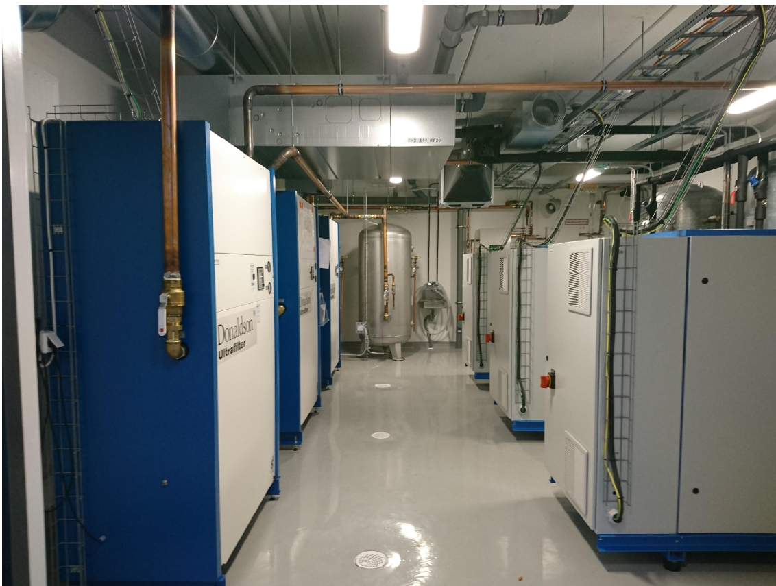
KUVA 2 Kompressorihuone suoraan ovelta kuvattuna
