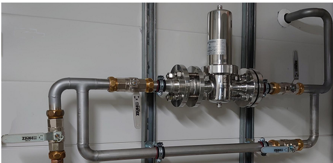
KUVA 21 Lääkkeellisen hapen suodatin, takaisku, huolto- ja ohitussulkuventtiilit
