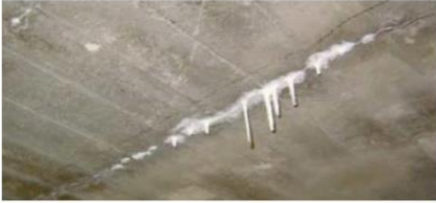
Kuva 2. Kalkkivuotoja kannen alapinnassa. (Väylävirasto 2018, 2.)
