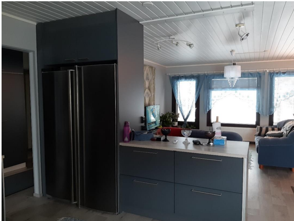
Kuva 21. Kylmälaitteiden kohta toteutuksen jälkeen. Entinen kalusteiden taustaseinä purettuna lattiat uusittuna, seinät ja katto maalattuna.
