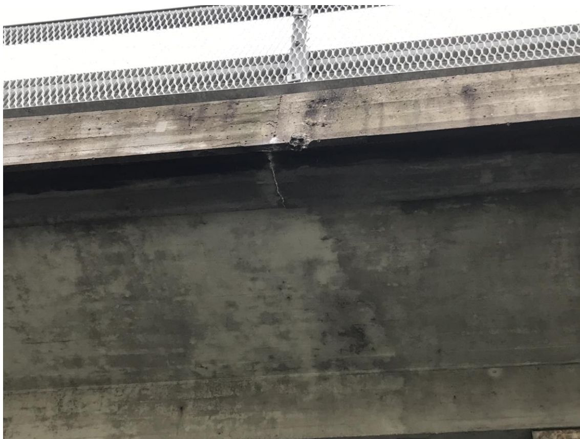
Kuva 2. Sillan reunapalkin halkeilu, (Ari Husso 2019).
