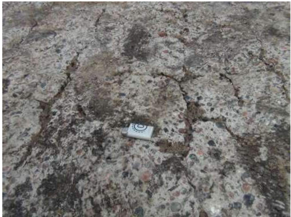
Kuva 7. Pintarakenteiden ja vesieristeiden poistamisen jälkeen kannen yläpinta voi näyttää ”ihan siistiltä” ja sovelialta vesieristysalustaksi. Korkeapainevesipesun jälkeen kannen yläpinta voikin sitten näyttää tältä.
