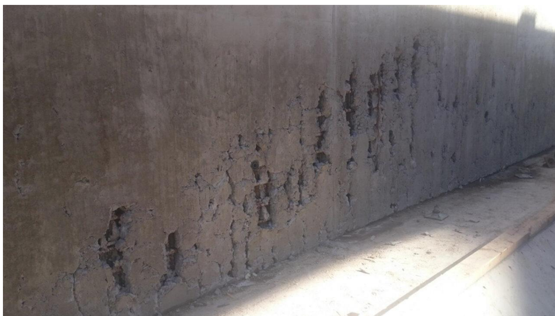
Kuva 5. Valutyössä oli puutteellista tiivistämistä, (rakennuslehti 2016).
