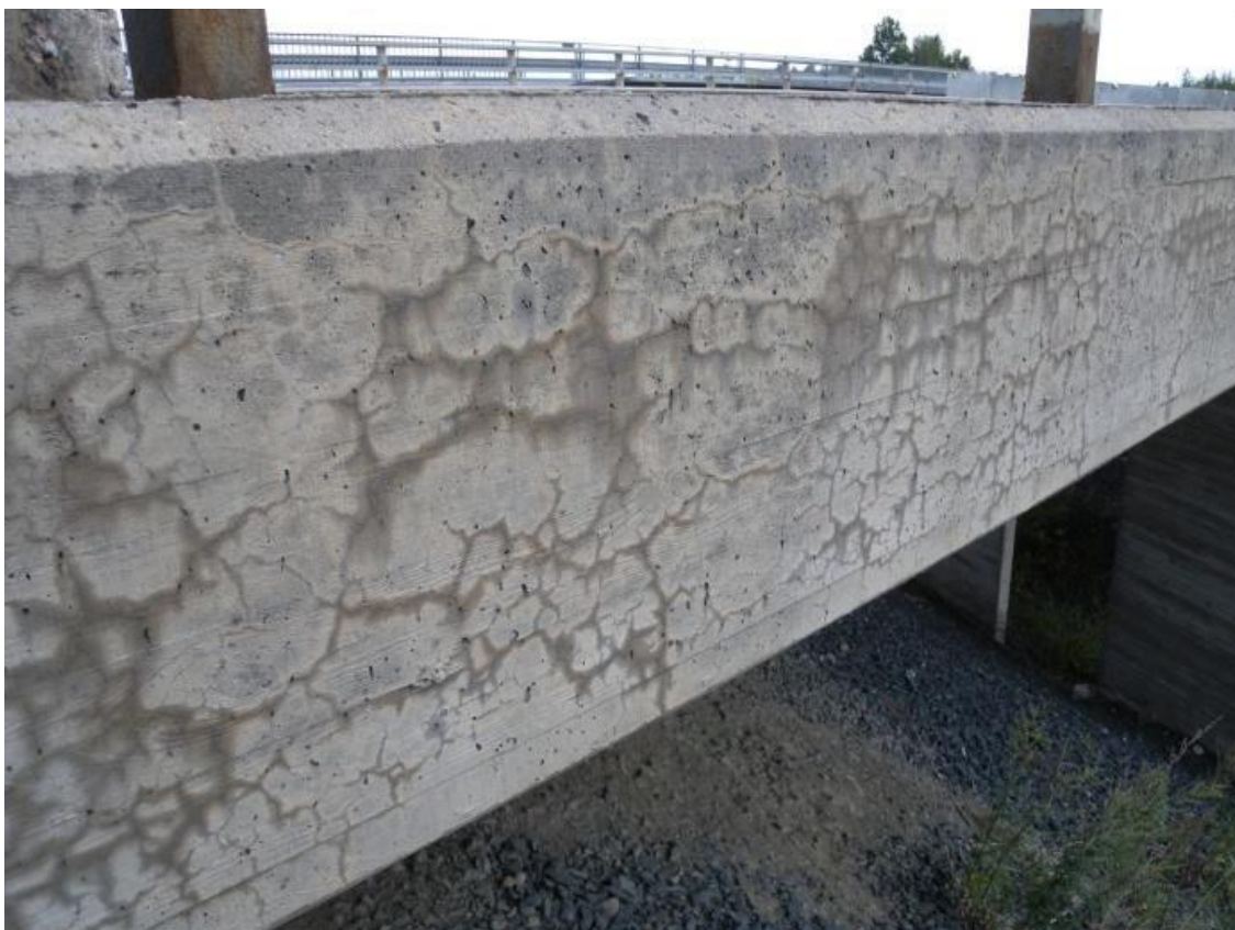
Kuva 3. Pakkasrapautuminen alkuvaiheessa, (Sillat 2018)
