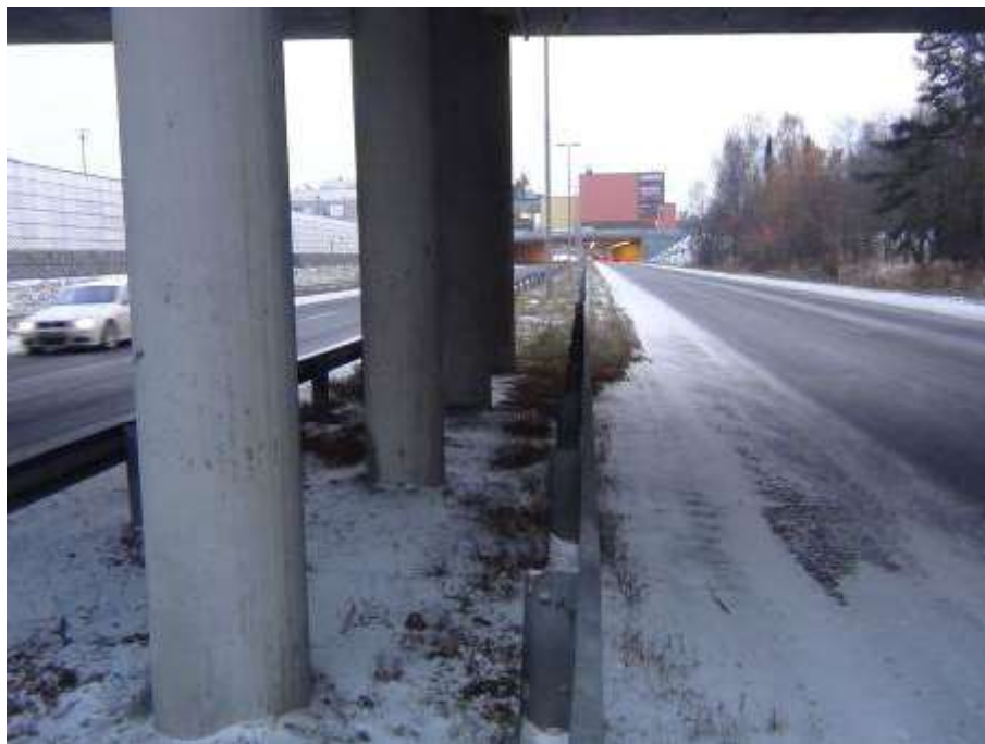
Kuva 2. Sillan alusrakenteet (välituki ja maatuot) ovat kovan suolarasituksen alaisina.
