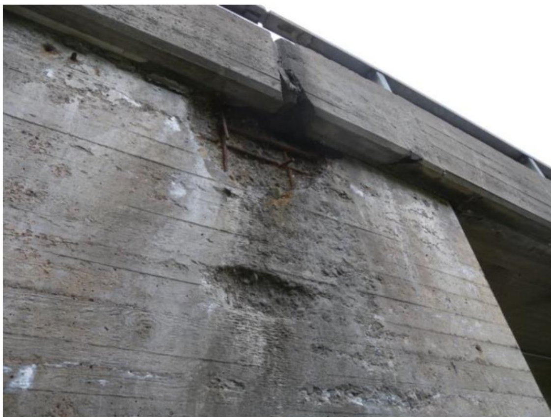
Kuva 4. Kloridipitoinen vesi aiheuttanut kloridikorroosio ja rapautuma, (Sillat 2018).
