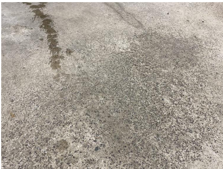
Kuva 16. Kemikaalirasituksesta syöpynyt betonilattia.
