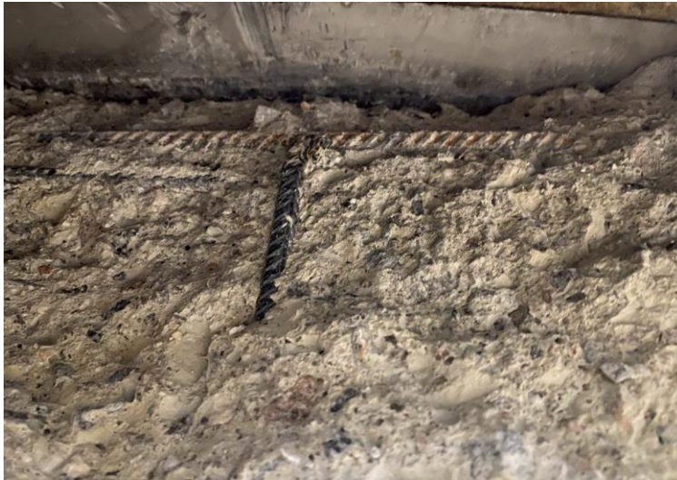
Kuva 6. Säiliöperustus on vaurioitunut niin, että betonirakenteen raudotteet ovat esillä.
