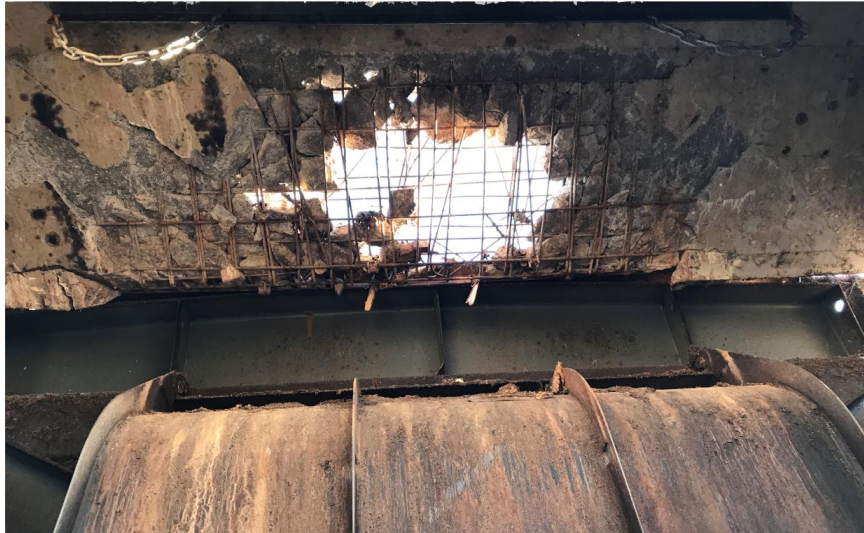
Kuva 12. Sulatinkuljettimen päätykannen vauriot betonirakenteen alapuolelta kuvattuna.
