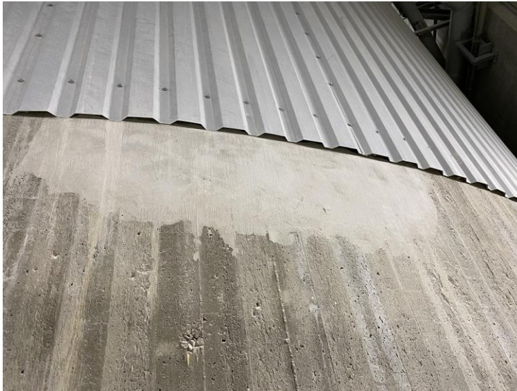
Kuva 8. Korjattu säiliöperustus, jonka pinnalle on muodostunut uudelleen mikrohalkeamia.
