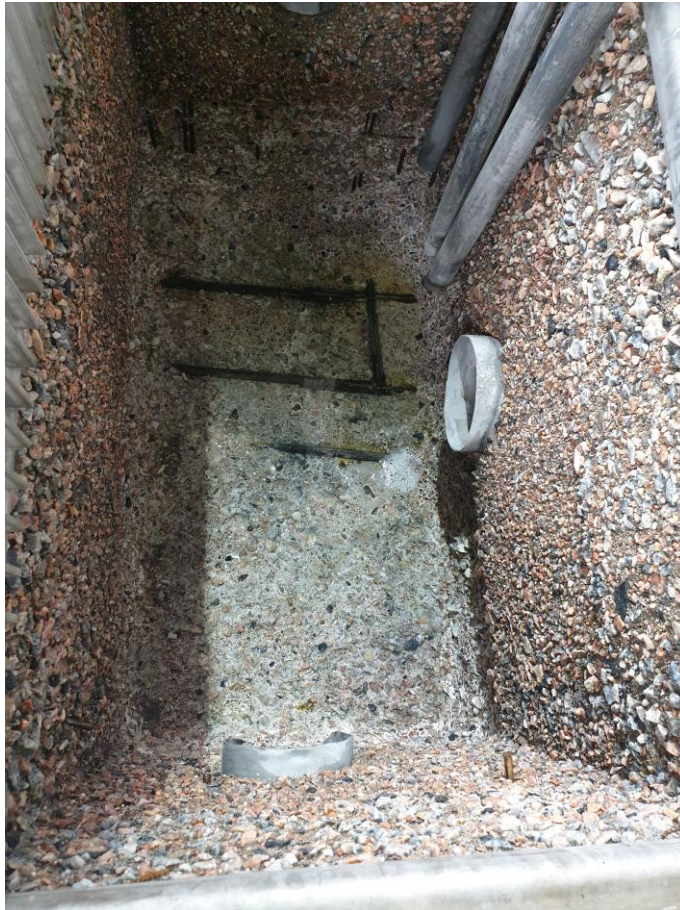
Kuva 14. Jätevedenpuhdistamon kemikaalipurkualueen kaivon pahasti vaurioitunut betonirakenne.
