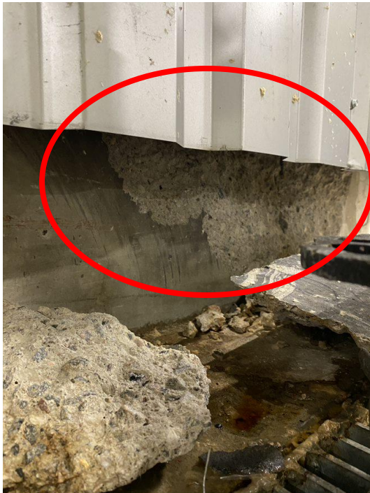
Kuva 5. Massatehtaan EOP-suodossäiliön perusmuurin yläreunasta on murtunut betonia.
