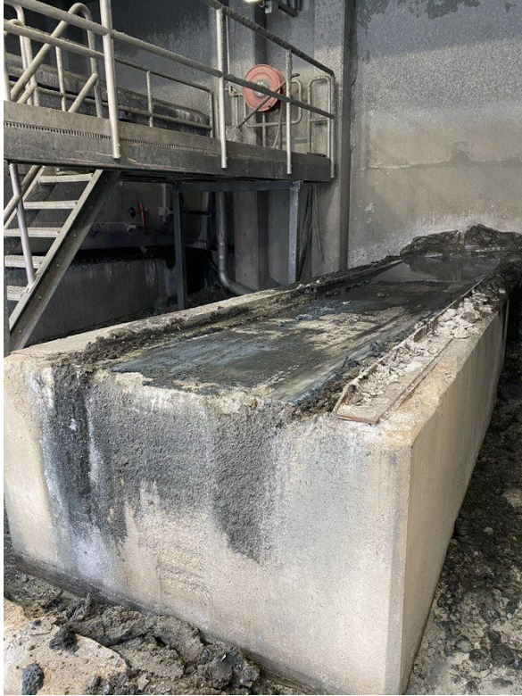
Kuva 18. Viherlipeänsakkalavan vaurioitunut betonirakenne.
