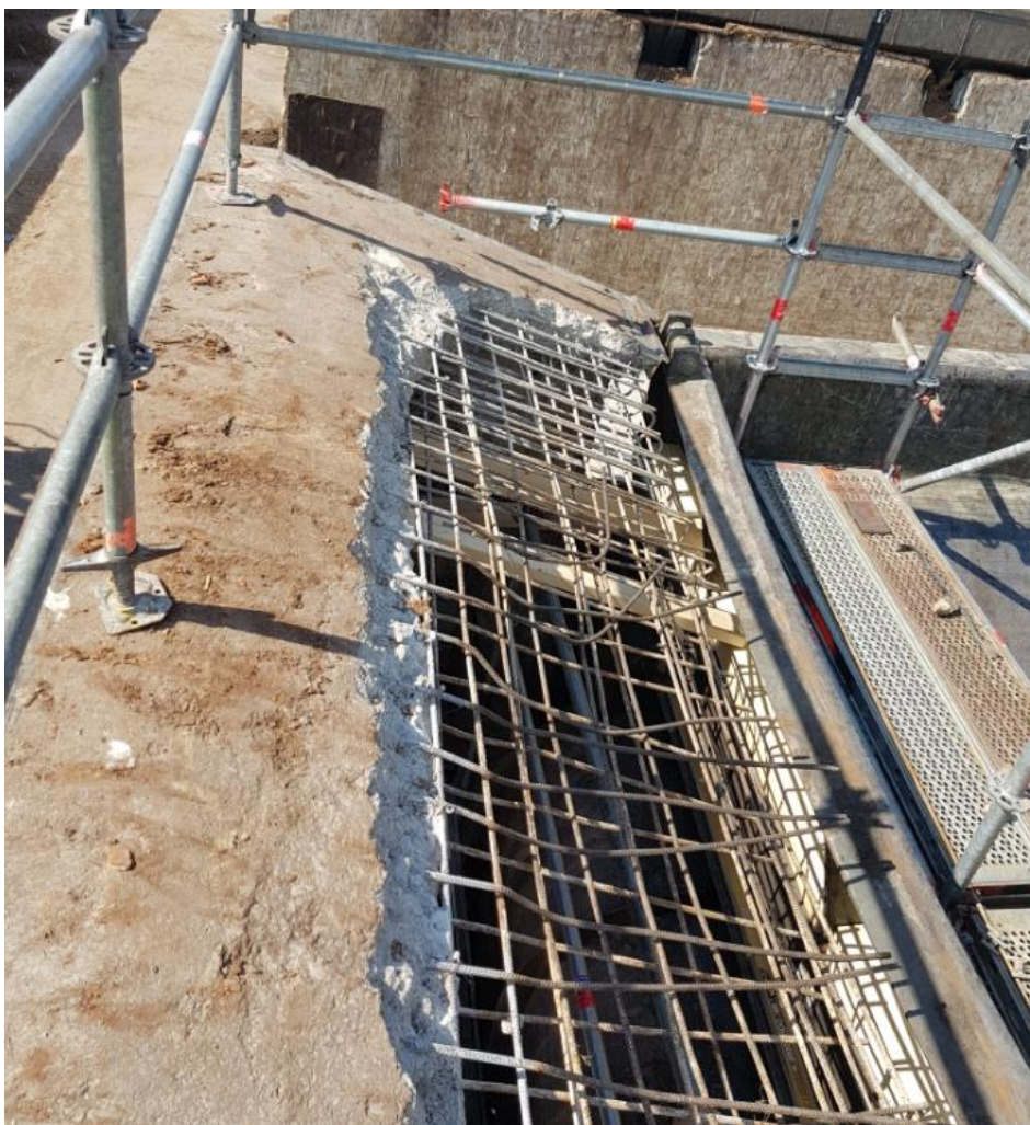
Kuva 13. Sulatinkuljettimen betonikansi, joka on piikattu puhtaaksi korjausta varten.
