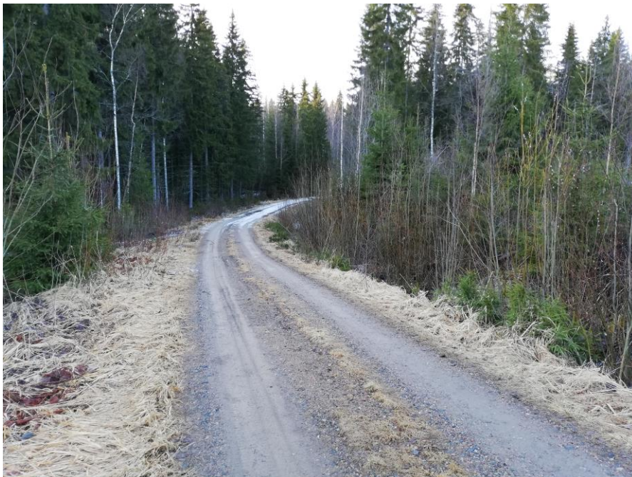
KUVA 1. Metsätie, jonka ojat ovat tukkeutuneet vesakosta (2020)
