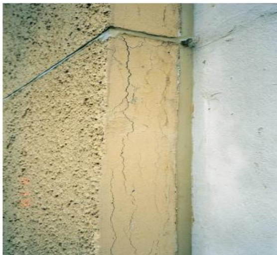
Kuva 10. Pakkasrapautunut pieliseinä [6, s. 5.]
