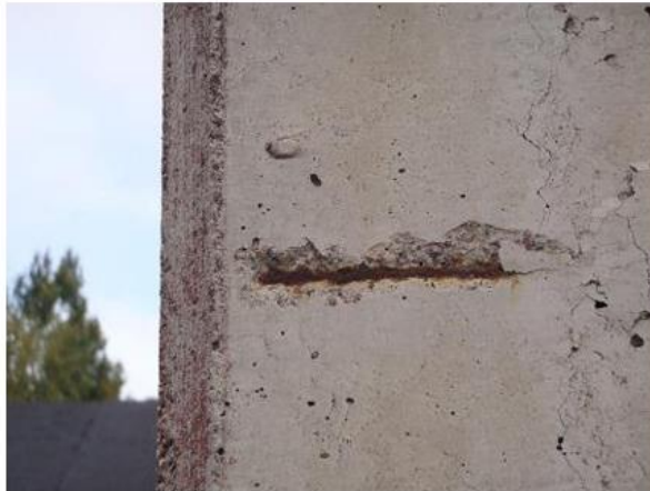
Terästen korroosion aiheuttama vaurio teräsbetonirakenteessa
