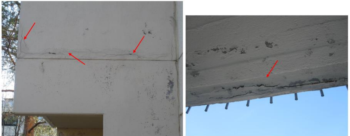
Kuva 15. Terästen korroosion aiheuttamia vaurioita parvekerakenteissa. [3, s. 16.]
