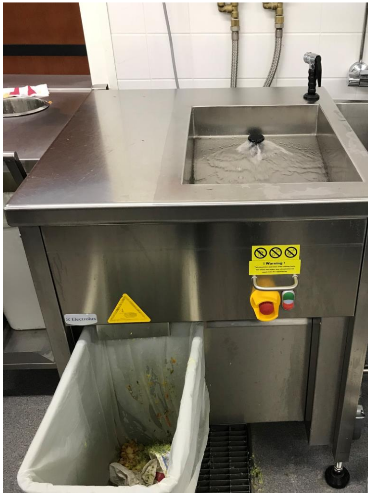
Kuva 6. Jätemylly eli biojätteen murskain. Kyseinen laite on omaan toimiva kokonaisuus, joka ei vaadi erillistä keskusyksikköä.
