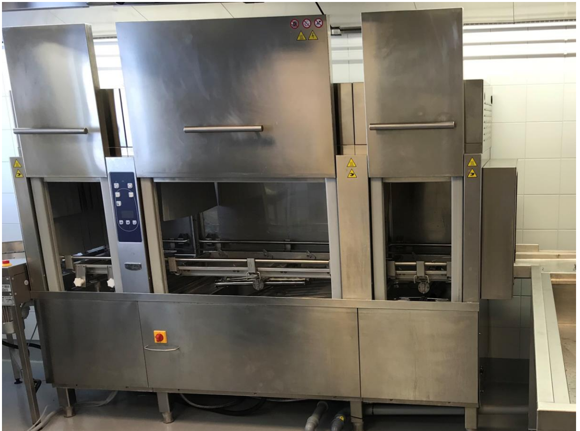
Kuva 3. Tunneliastianpesukone, jossa kulkusuunta oikealta vasemmalle. Laitteessa on esipesulohko, pesulohko ja huuhtelulohko. Lopussa on vielä moottorivetoinen kulmakaarre.
