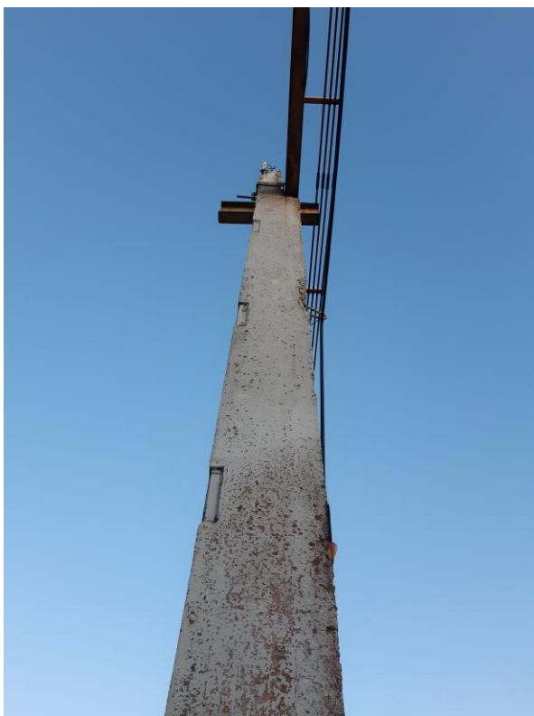
Pilarin n:o 8 yläpää pahoin rapautunut
