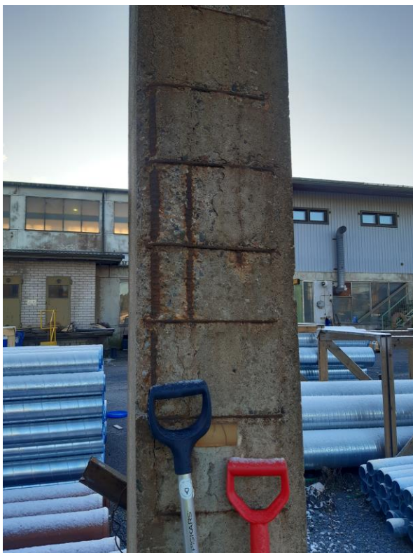
Samoin pilarista n:o 5. Pääteräksiä tuntuisi olevan reilusti, kunhan ne saisi vain betoni- peitteen alle suojaan.
