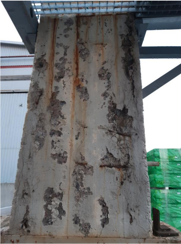
Pilari n:o 4 suojabetonin vahvuus olematon ja pääterästen korroosion aiheuttamat halkeamat ja lohkeamat näkyvissä.
