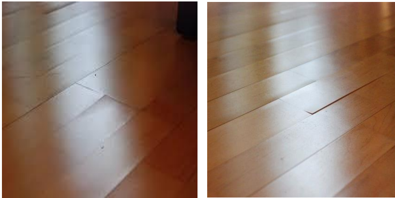
Kuva 16. Vaurioitunutta parkettilattiaa. Onko vika ilmankosteudessa? Vai ”elämisvarassa”?
