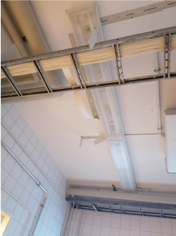
Kuva 16. Katto ja siihen kiinnitettyä tekniikkaa.
