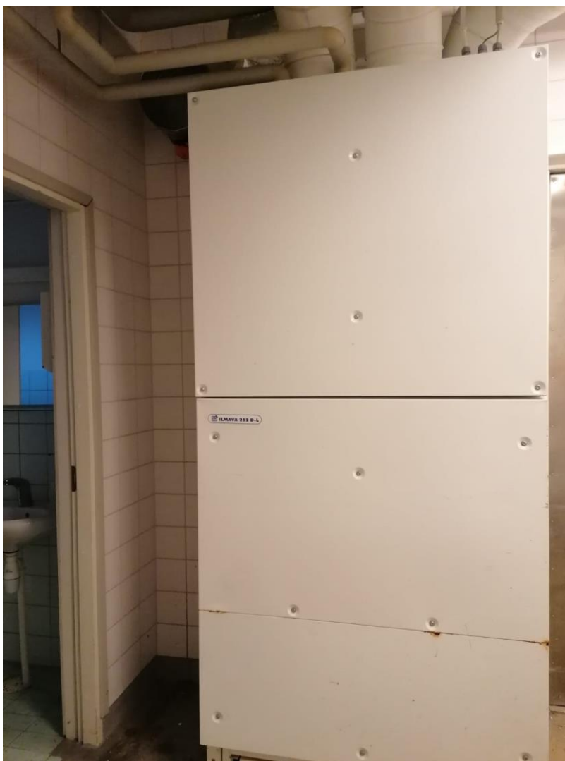
Kuva 22. Eteisessä sijaitseva ilmanvaihtokone.
