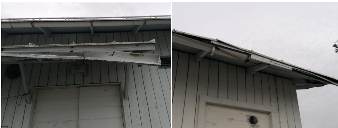
Kuvat 8. ja 9. Vasemmalla lähtevän kalan -tilan rikkiäinen katos ja oikealla vastaavaa vauriota toisella puolella rakennusta.
