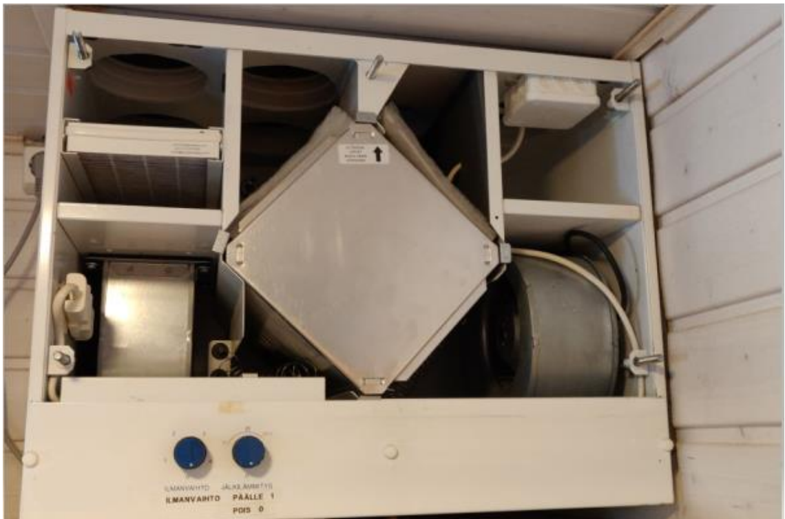
Kuva 7. Lämmöntalteenotolla varustettu IV -kone
