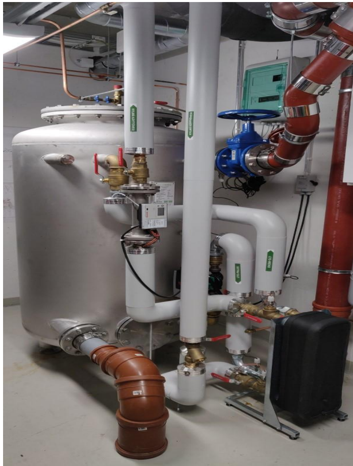
Kuva 9. Ecowec hybridivaihdin Kelon teknisessä tilassa
