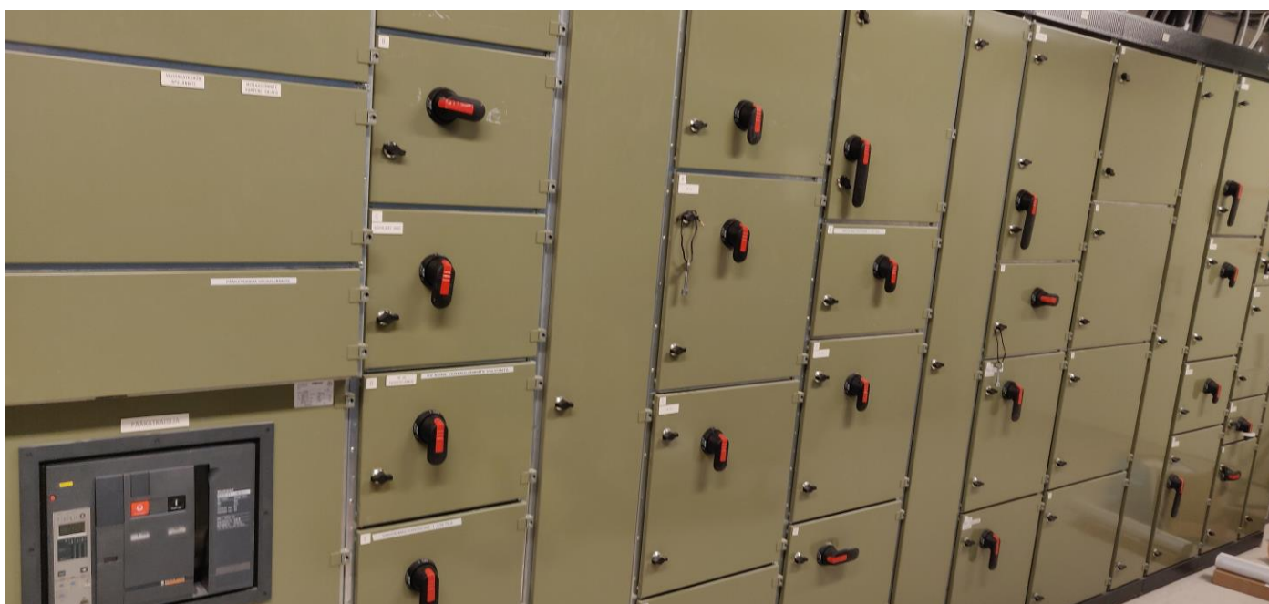
Kuva 1. Normaaliiverkon sähköpääkeskus, Satasairaalan O-rakennus 2020.
