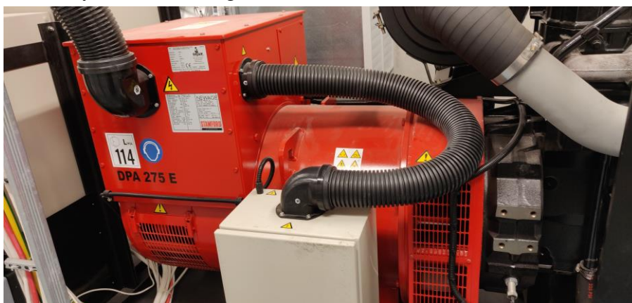
Kuva 10. Vaihtovirtageneraattori, Satasairaalan O-rakennus 2020.
