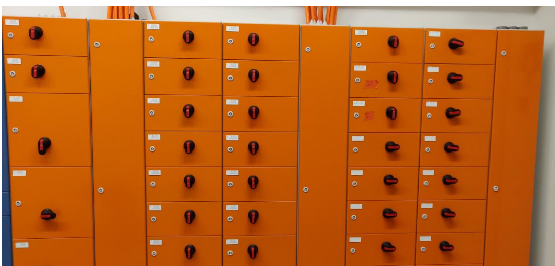
Kuva 15. UPS-keskus, Satasairaalan E-rakennus 2020.
