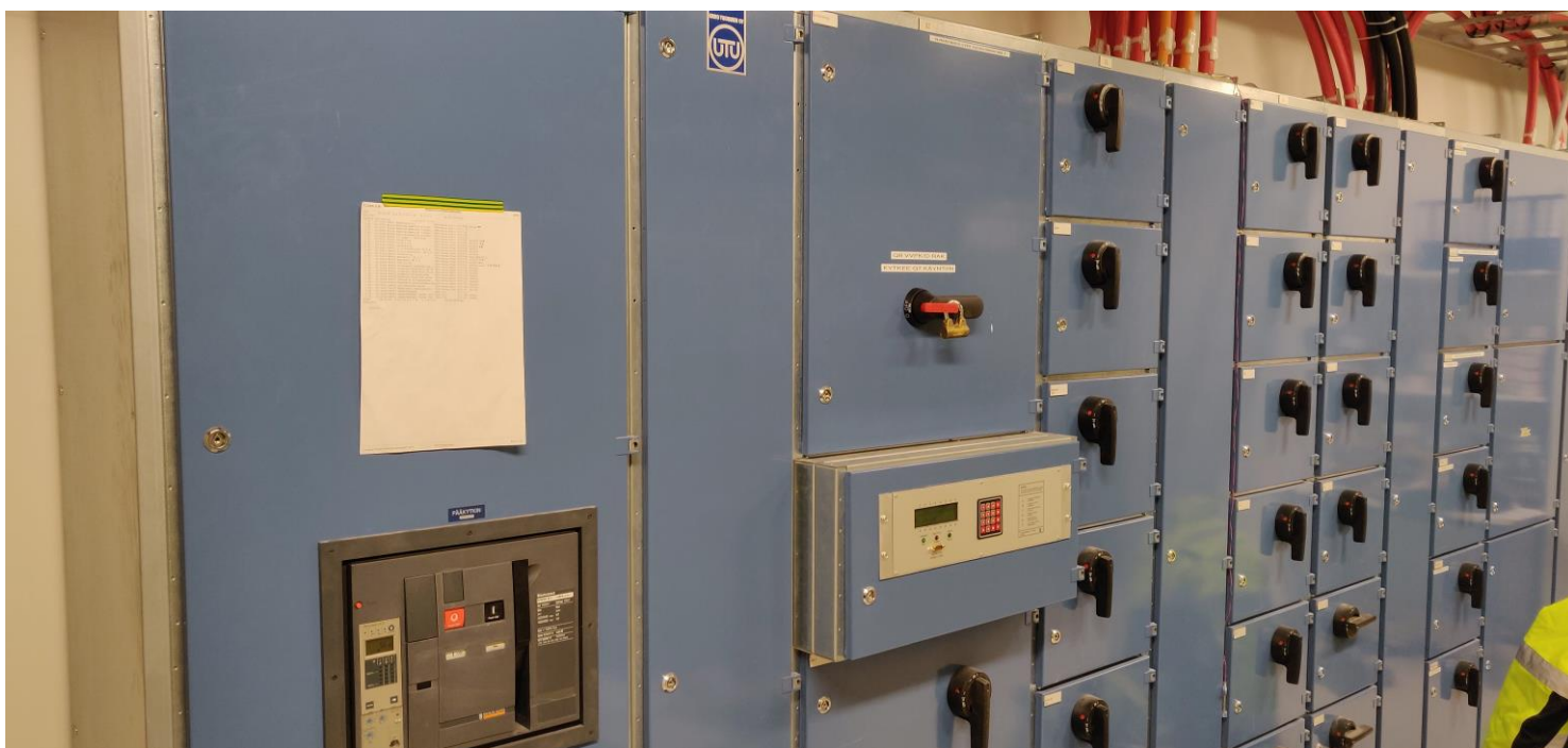
Kuva 5. VV-pääkeskus Satasairaalan O-rakennus 2020.
