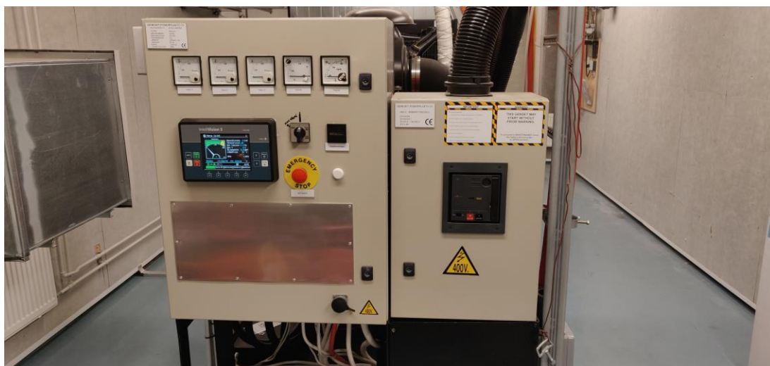
Kuva 11. Varavoimajärjestelmän ohjaus- ja hallintalaitteisto, Satasairaalan O-rakennus 2020.
