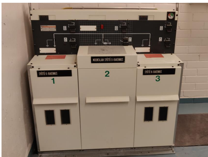
Kuva 2. Keskijännitekojeisto, Satasairaalan O-rakennus 2020.
